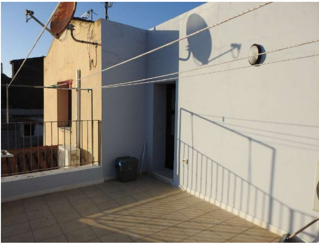
Figura 23 - Terrazza abusiva. Visuale verso porta finestra dell'ultimo pianerottolo
