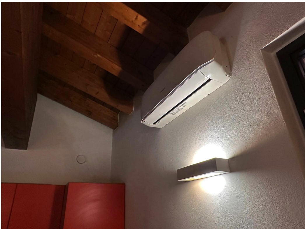
Foto 23 - Impianto di condizionamento
