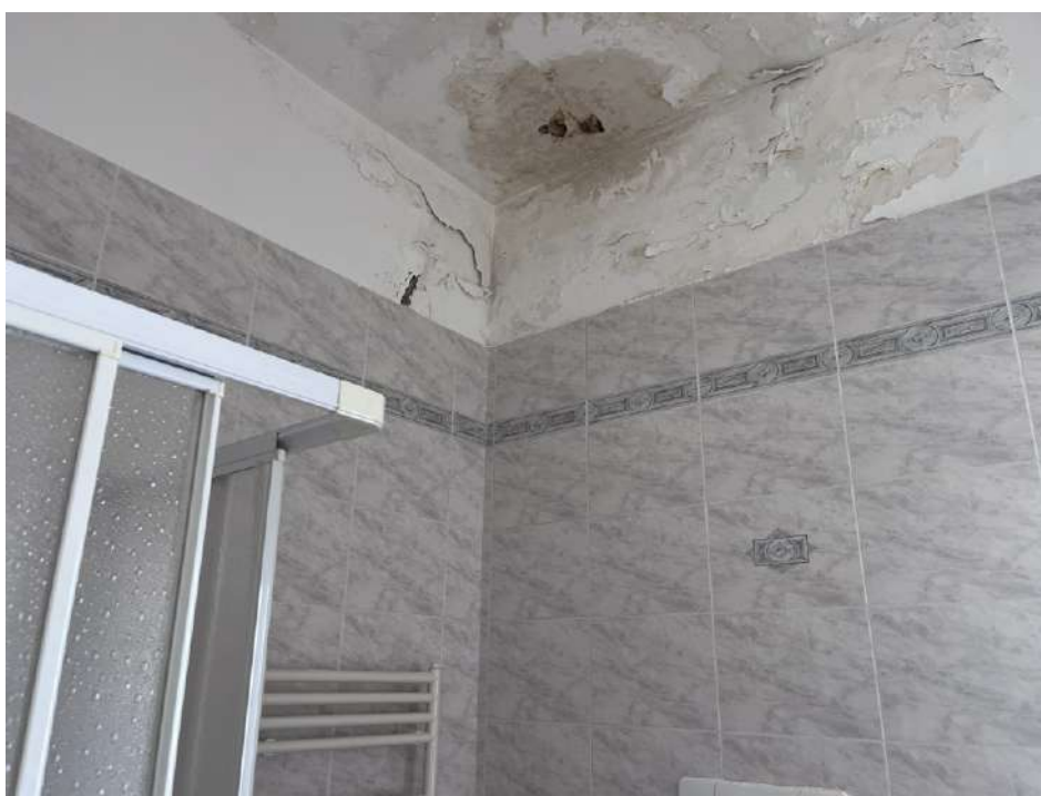
IMMAGINE 7: Aberrazione estetica e funzionale ubicata sulle superfici del servizio igienico
