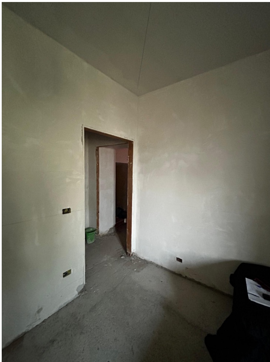
FOTO 7. MANCANZA DI INFISSI INTERNI
