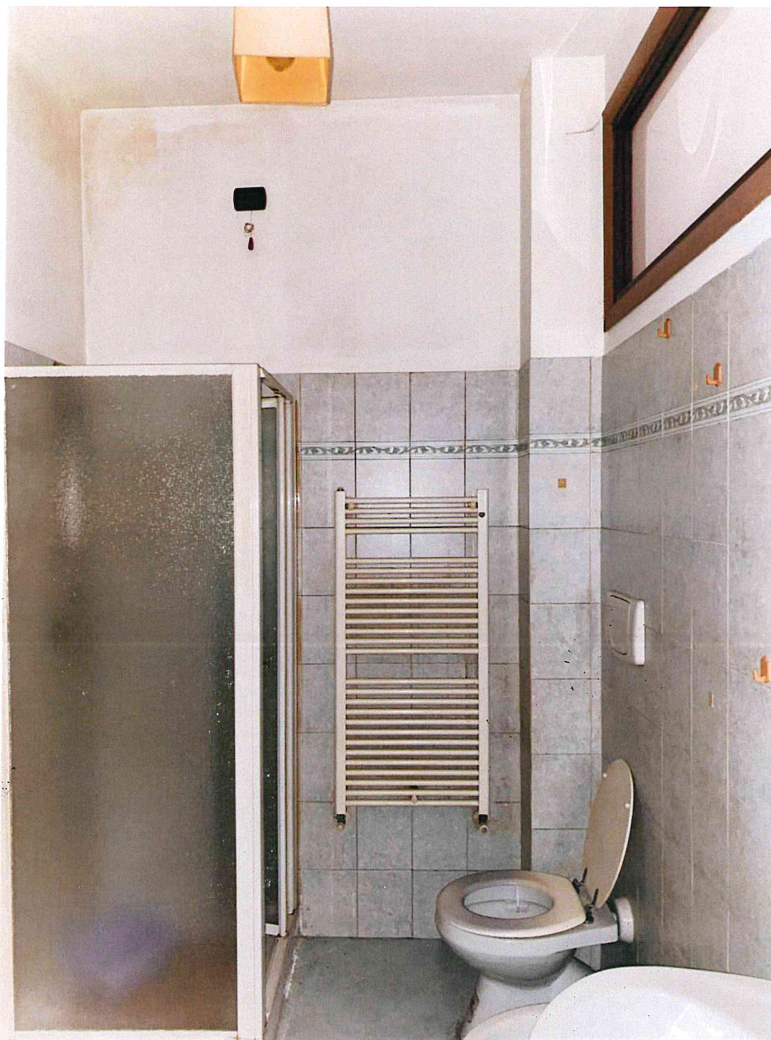
FOTO 6: TREZZO D'ADDA, via Torre 36, bagno
