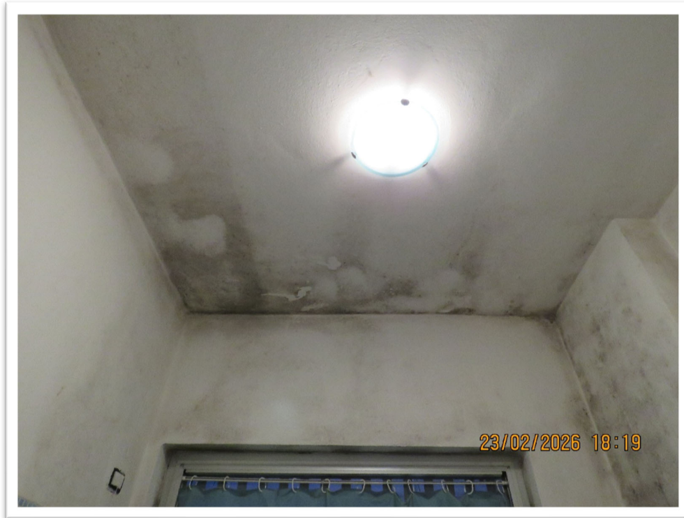
Particolari del degrado diffuso sulla maggior parte dei plafoni.
