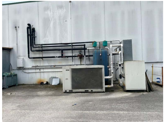
FOTO 10 Vista impianti su lato Nord
