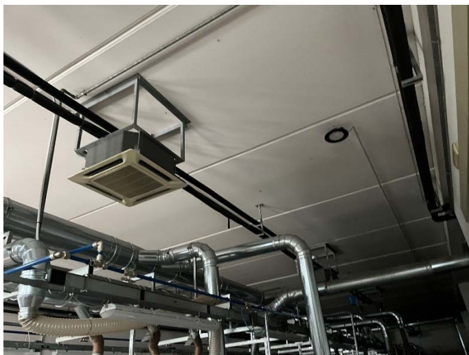
FOTO 79 Vista interno impianto tecnologici
