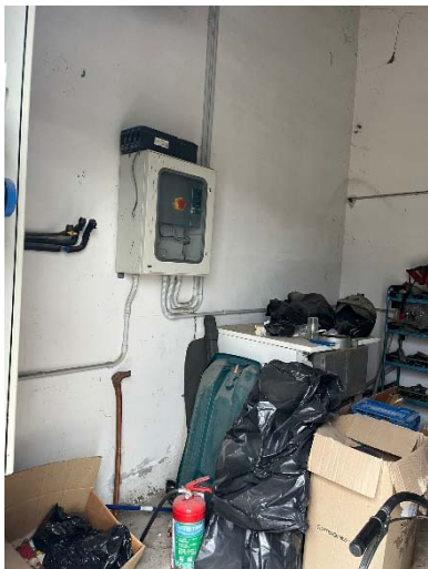
FOTO 131 Vista interno locale C.T.
