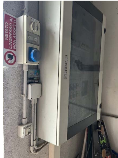
FOTO 130 Vista interno locale C.T.
