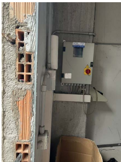
FOTO 127 Vista interno locale C.T.
