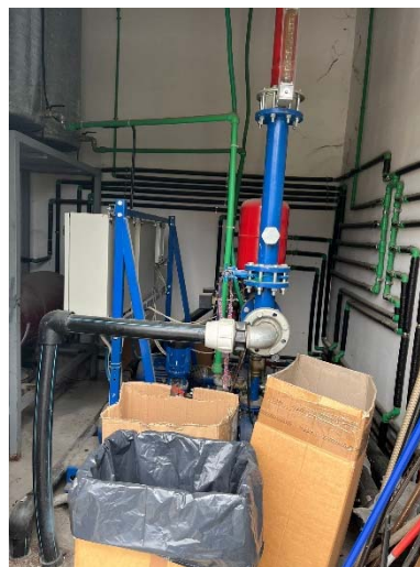
FOTO 128 Vista interno locale C.T.
