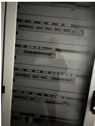
FOTO 63 Vista Quadro Elettrico
