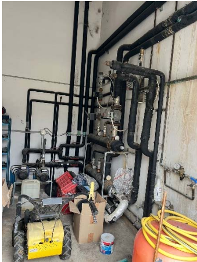
FOTO 129 Vista interno locale C.T.
