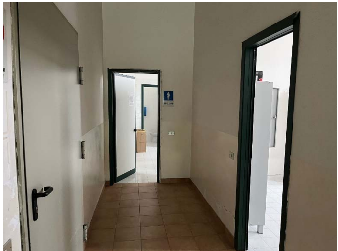
FOTO 84 Vista interno disimpegno spogliatoi/servizi
