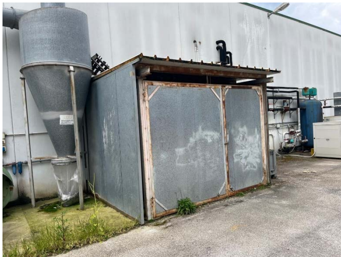
FOTO 11 Vista impianti su lato Nord
