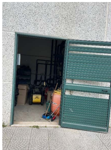
FOTO 20 Vista locale C.T.
