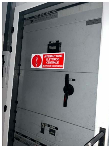
FOTO 64 Vista Quadro Elettrico
