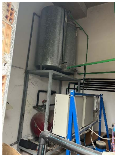
FOTO 126 Vista interno locale C.T.
