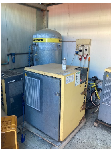
COMPRESSORE – ESSICCATORE ARIA - SERBATOIO
