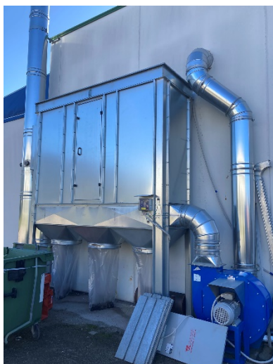
IMPIANTO DI ASPIRAZIONE (FILTRO A MANICHE)
