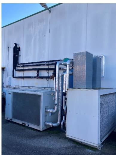
IMPIANTO DI CONDIZIONAMENTO (CHILLER)
