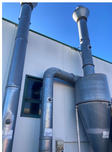
IMPIANTO DI ASPIRAZIONE (CICLONE)
