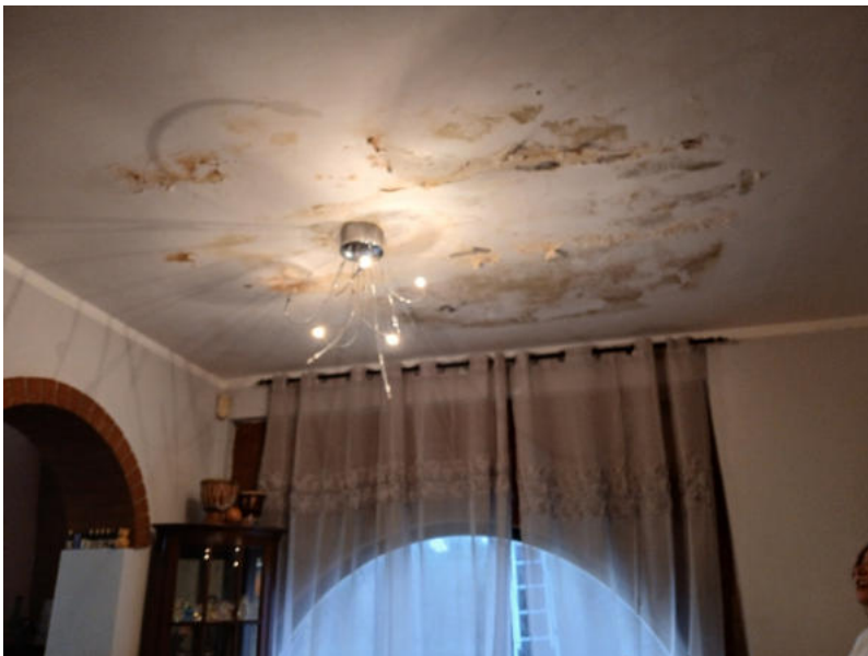
Infiltrazioni in zona soggiorno
