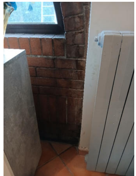
Infiltrazioni in zona soggiorno
