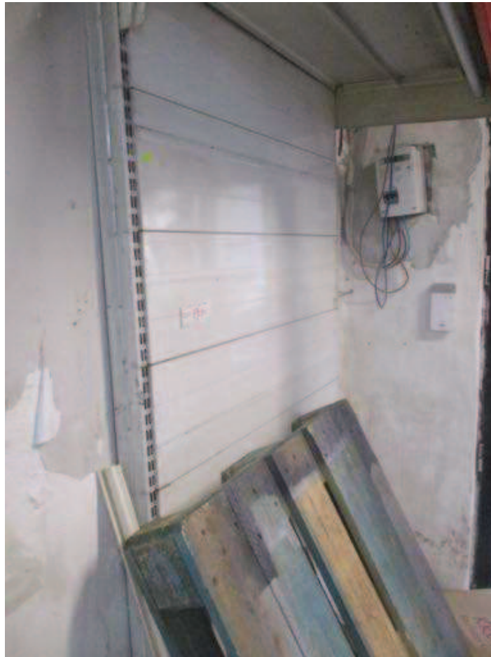
Foto 11- vista della posizione della ex porta di accesso dal vano scala civ.89
