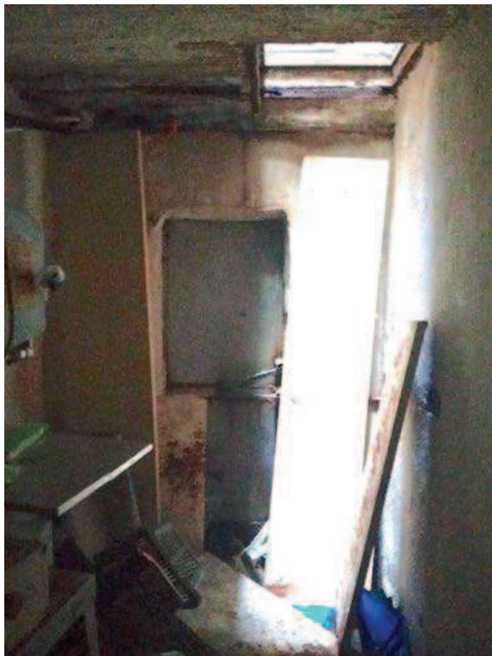
Foto 18- vista interna della parete tra antibagno e restante porzione del pozzo luce
