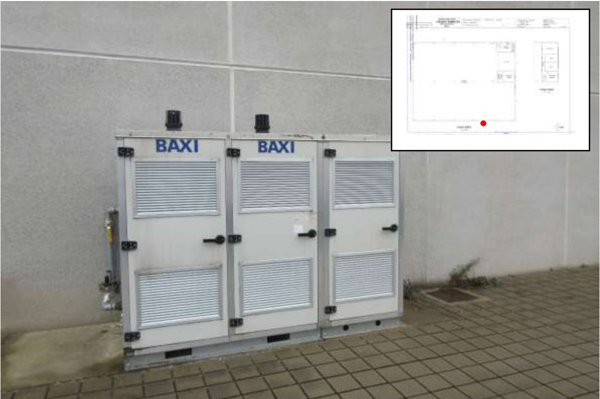
Caldia esterna dell'impianto di riscaldamento
