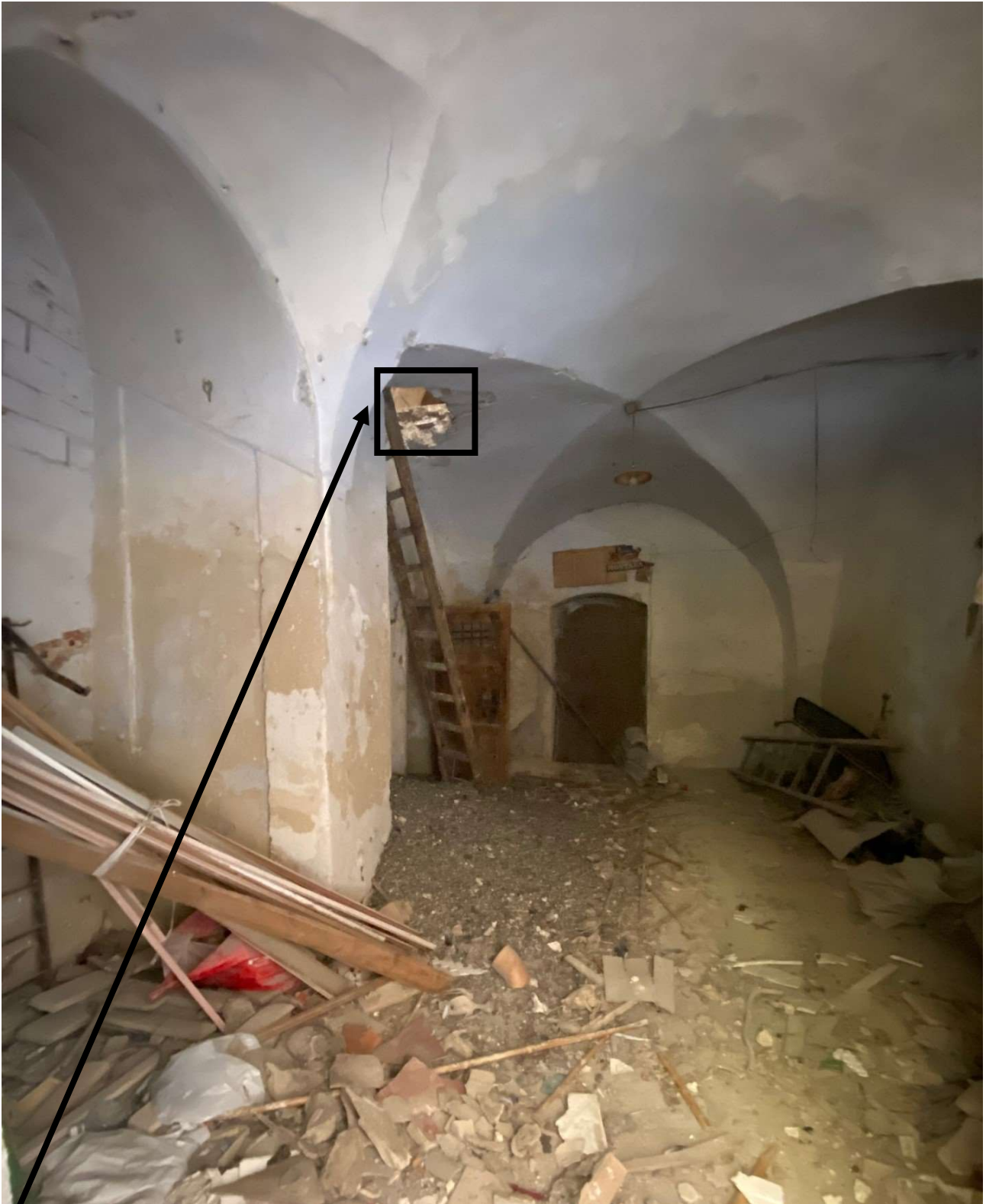
Porzione di solaio crollato, da cui si accede al Piano Primo (tramite scala in legno)
