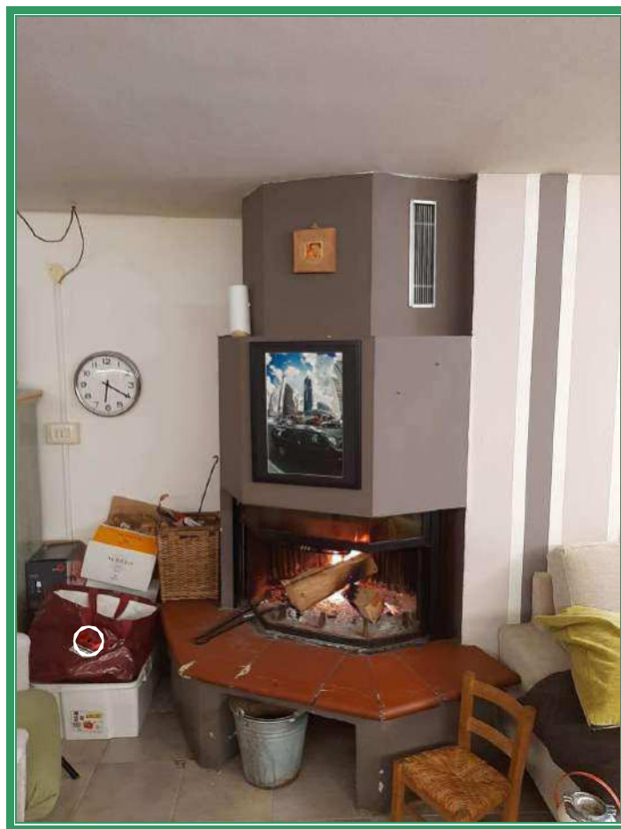
Foto 27) Termocamino ubicato in garage
