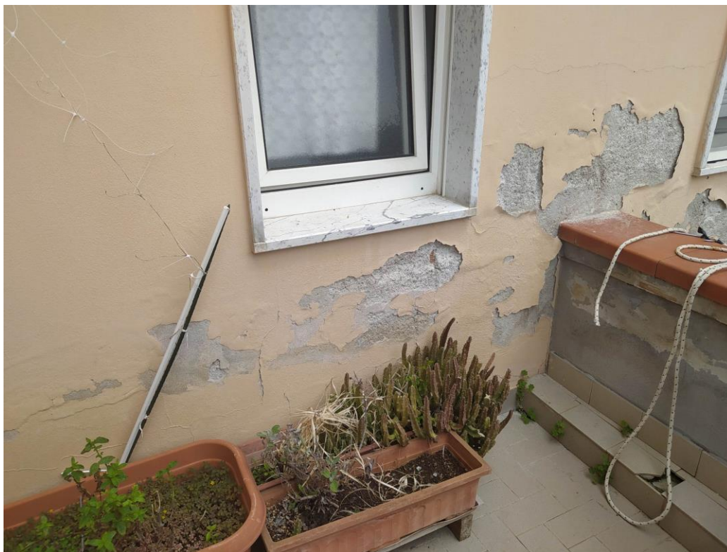
Foto n.19: Vista di alcune zone della facciata che necessita di manutenzione
