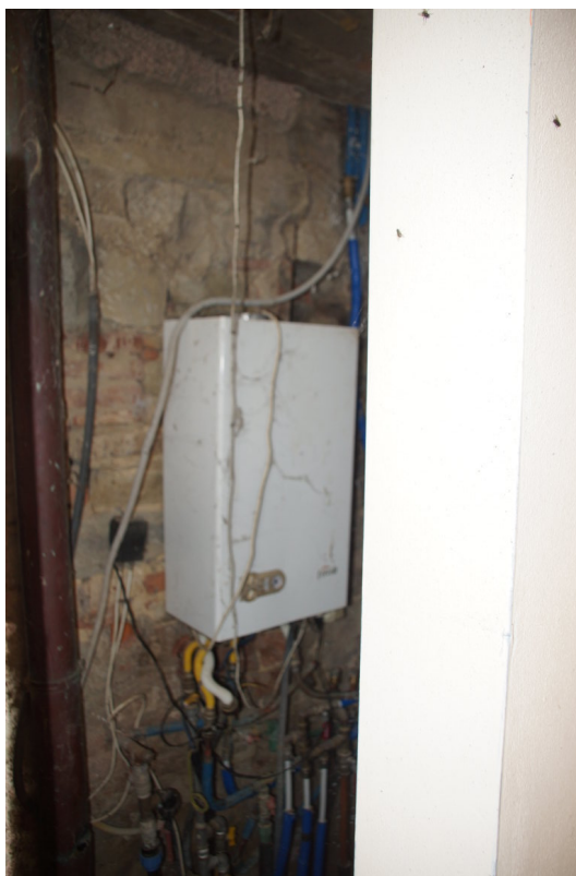
Foto n°41: particolare della caldaia a GPL non utilizzata.
