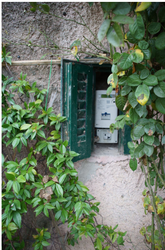
Foto n°42: particolare dell'alloggiamento del contatore della luce posto al piano terra lungo la corte.
