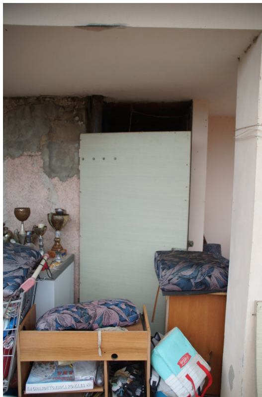
Foto n°40: particolare dell'alloggiamento della caldaia a GPL non utilizzata posto lungo il portico al piano terra.
