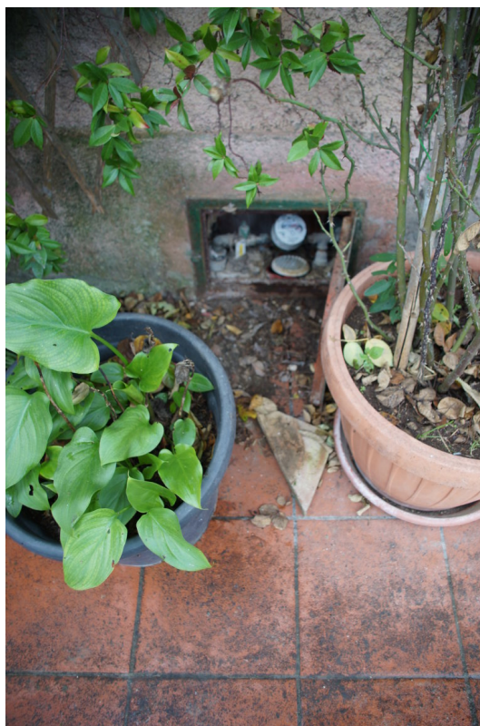
Foto n°43: particolare dell'alloggiamento del contatore dell'acqua posto al piano terra lungo la corte.
