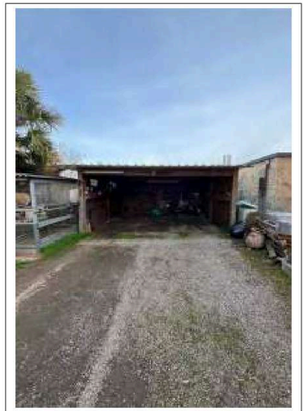
20. TETTOIA A CONFINE NON AUTORIZZATA DA TITOLI EDILIZI
