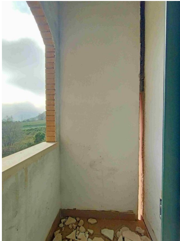
Foto 12: AMMALORAMENTI - BALCONE SUB. 26 PIANO 2
