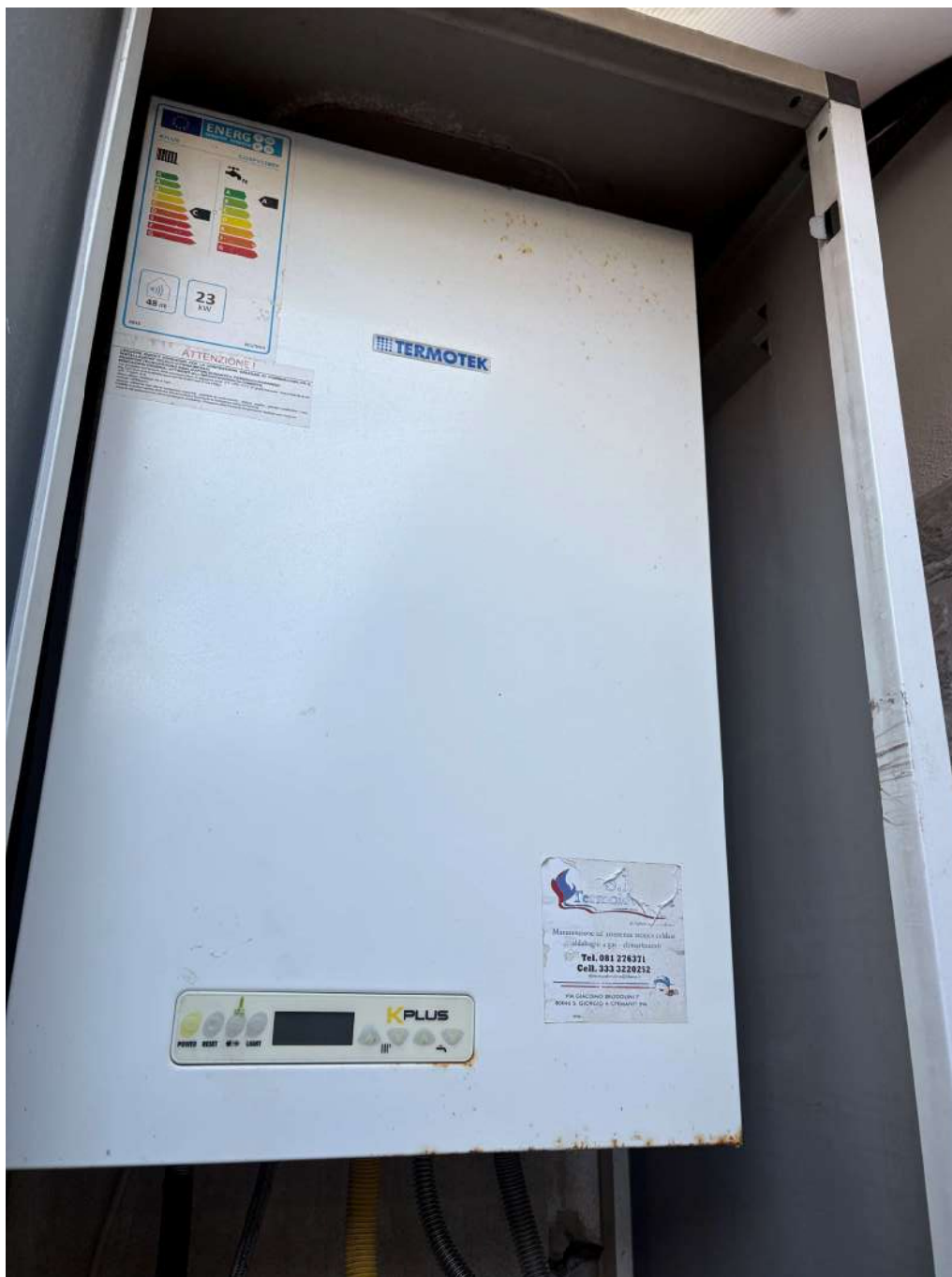
Foto n. 10: • Caldaia installata in armadietto esterno.
