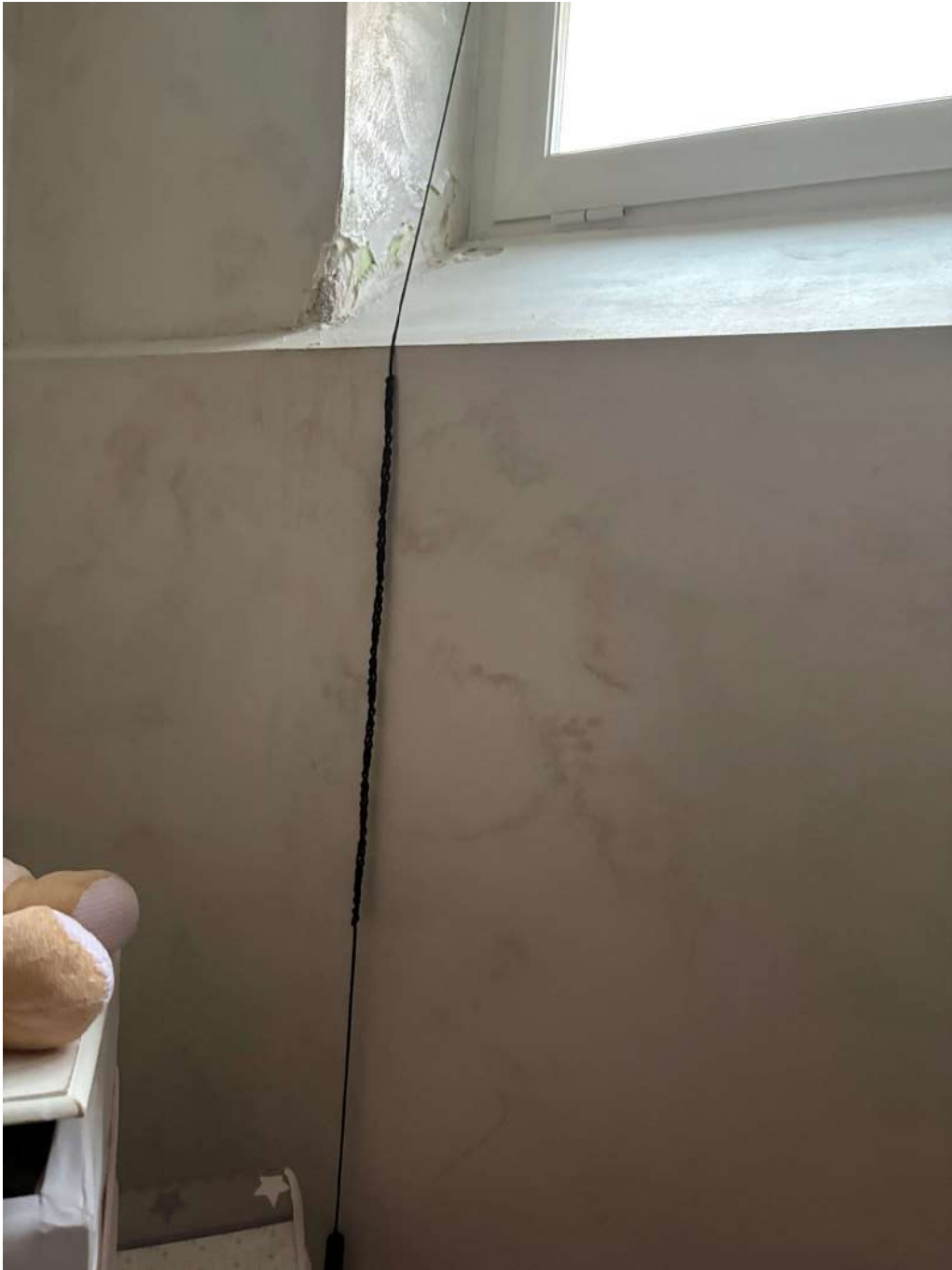
Foto n. 20: • Tracce di umidità da terrapieno.
