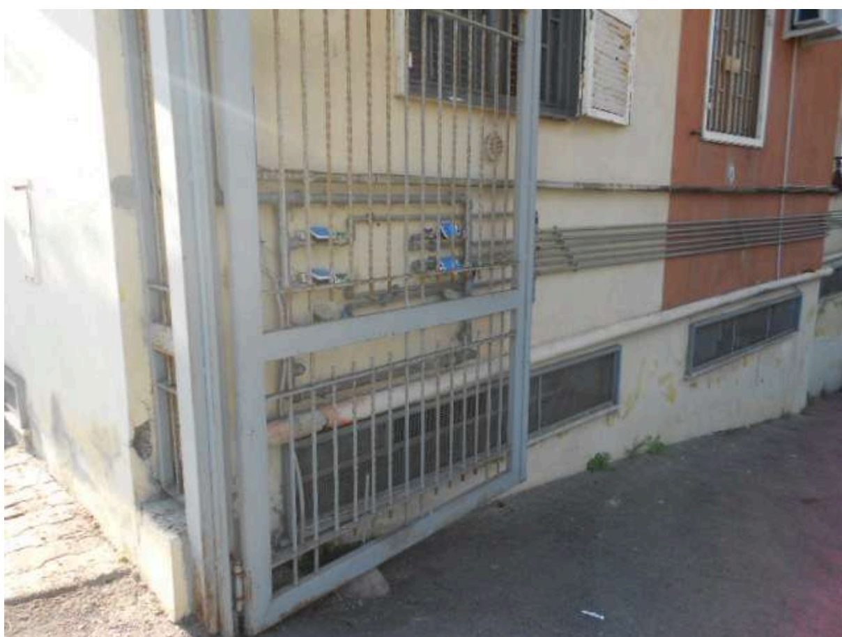
Foto n. 7: • Batteria di contatori idrici comprendente il misuratore asservito all'immobile pignorato.
