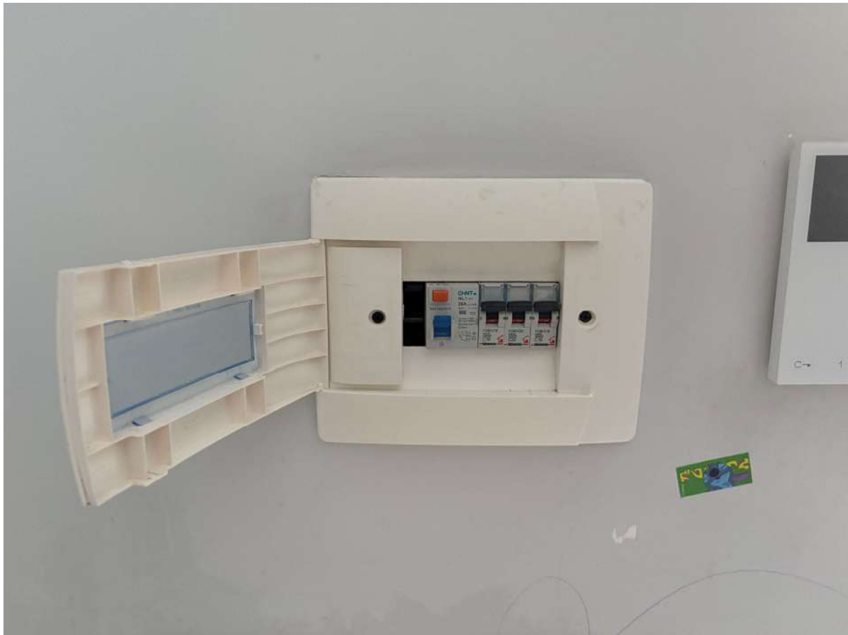
Foto n. 22: • Quadro elettrico generale.
