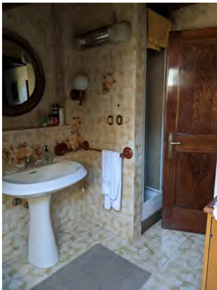
Foto n° 36: Piano quarto: bagno.
