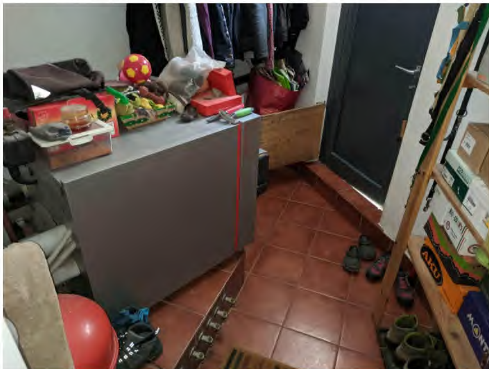
Foto n° 47: Zona residenziale, piano terra: centrale termica.
