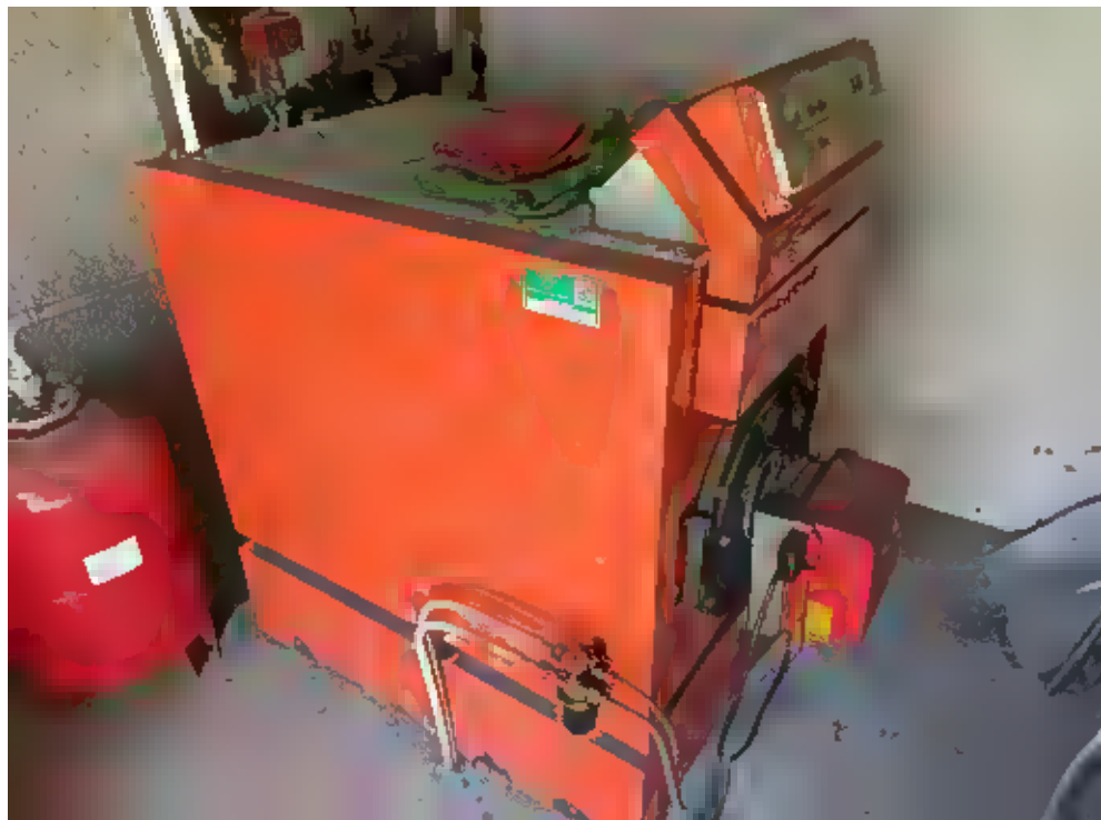
Foto n° 8: Piano terra: locale caldaia.
