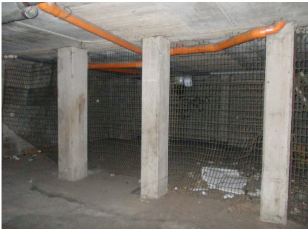
Foto 8 Particolare box fg.24 mapp.85 sub.56 inagibile
