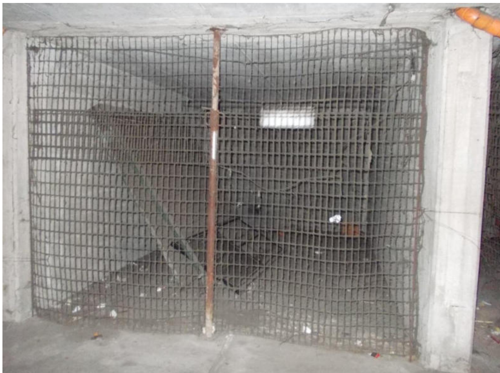
Foto 7 Particolare box fg.24 mapp.85 sub.56 inagibile
