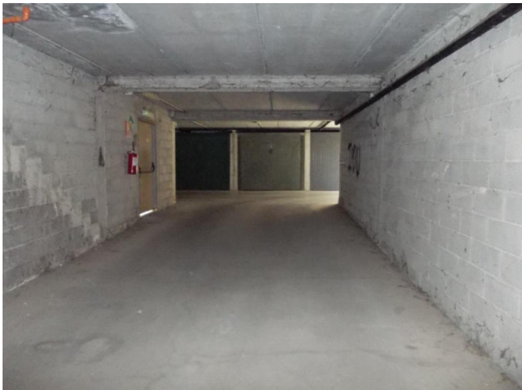
Foto 5 Corridoio di manovra comune
