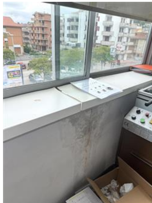
Problematica infiltrazioni infissi
