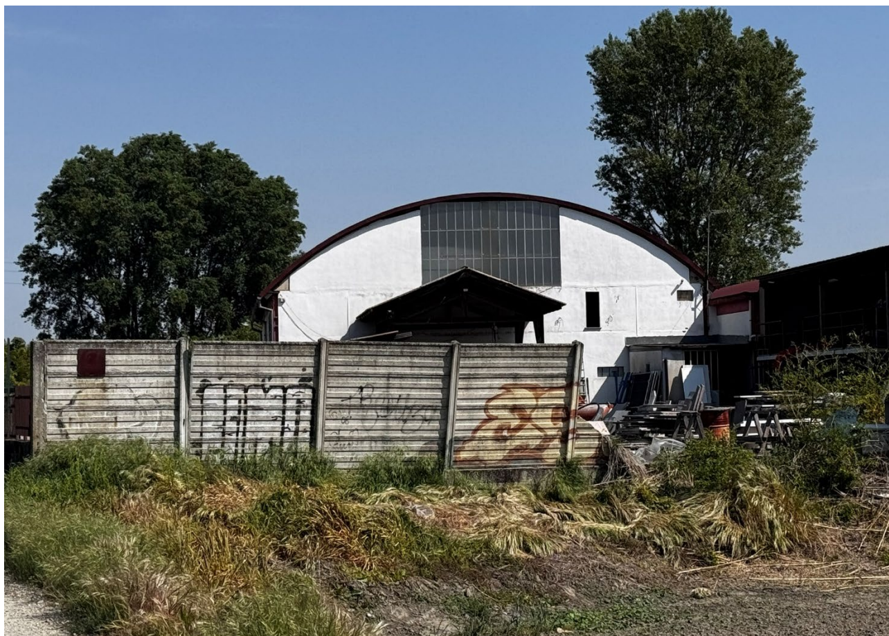
31. completo cedimento di parte della delimitazione verso la particella 114.
