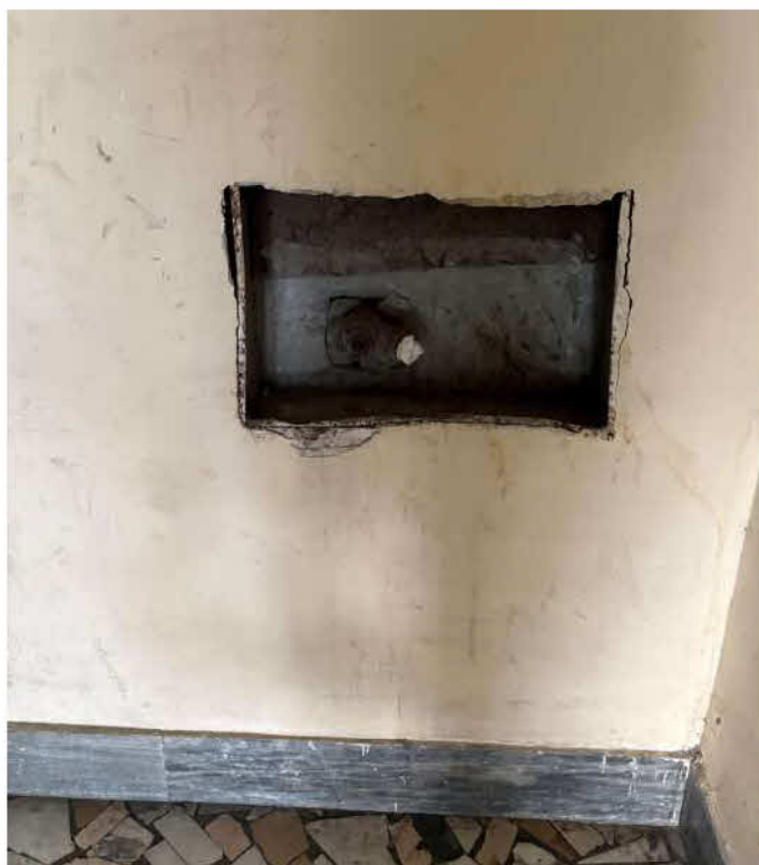
Foto n. 10: • Installazioni riconducibili ad impianto antincendio del fabbricato, ma prive di “manichette”.
