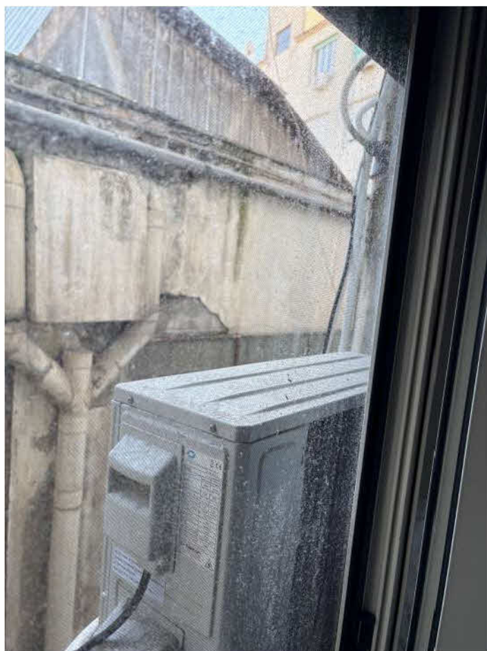
Foto n. 19: • Affaccio tipico posteriore (si vede il capannone addossato al fabbricato).
