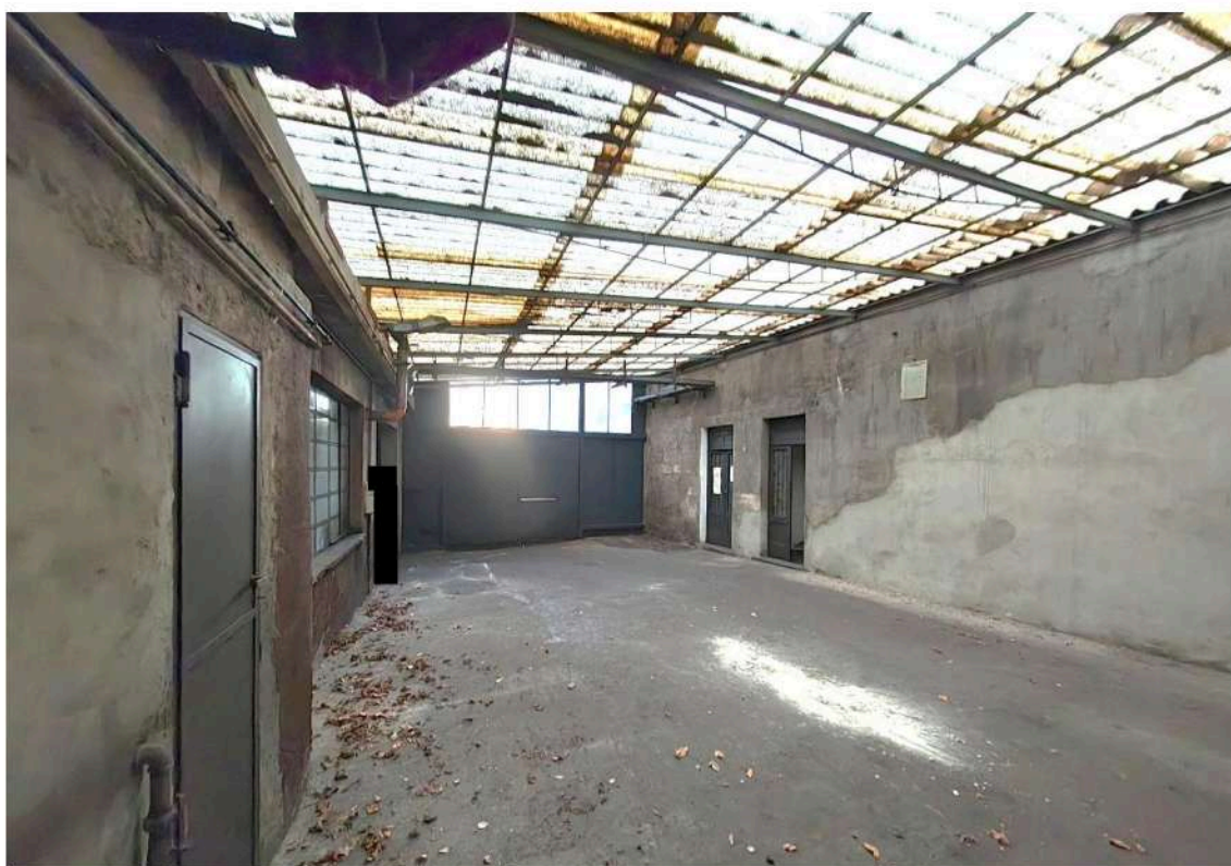
Vedute del deposito esterno chiuso in assenza di titolo (dovrebbe essere tettoia)
