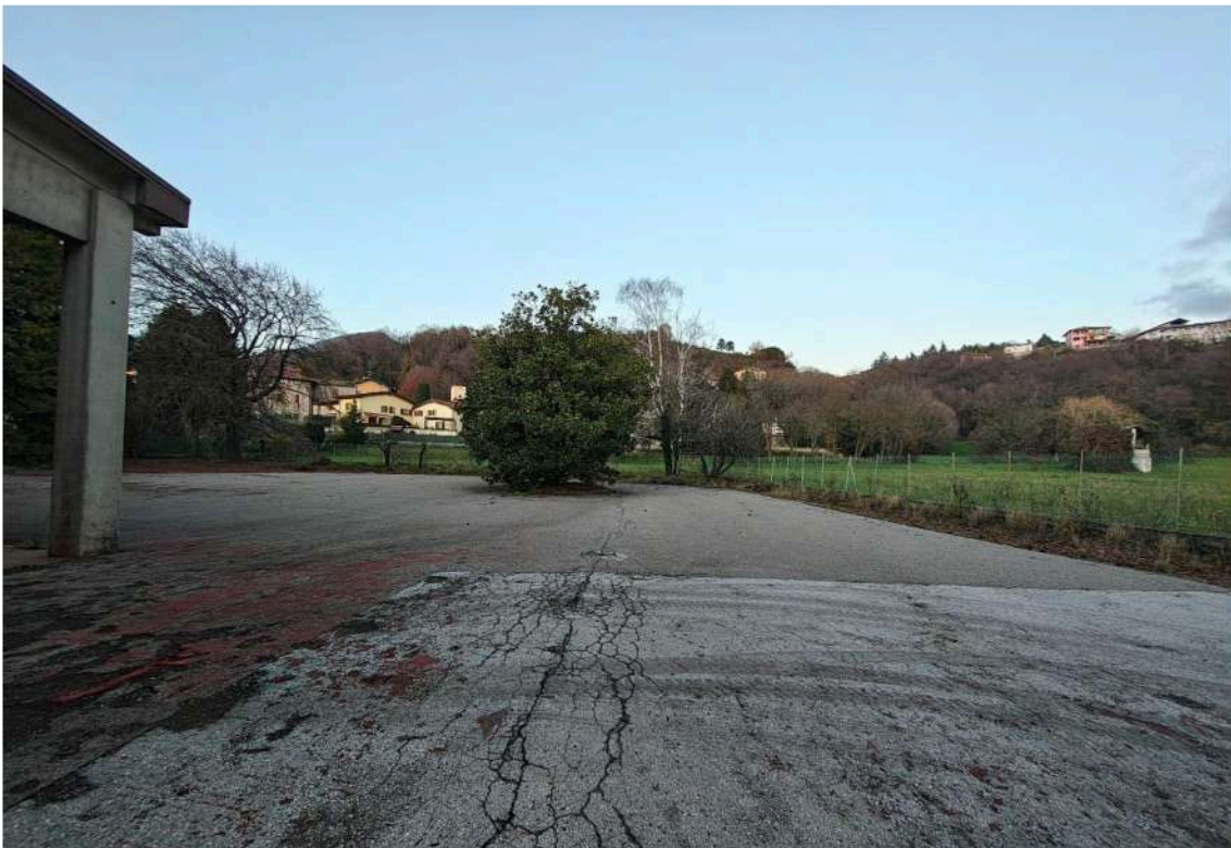
Veduta della porzione retrostante il capannone. Si noti che la pozione asfaltata verso il fondo deve essere ripristinata poiché non può essere tenuta in asfalto ma riportata ad agricolo.
