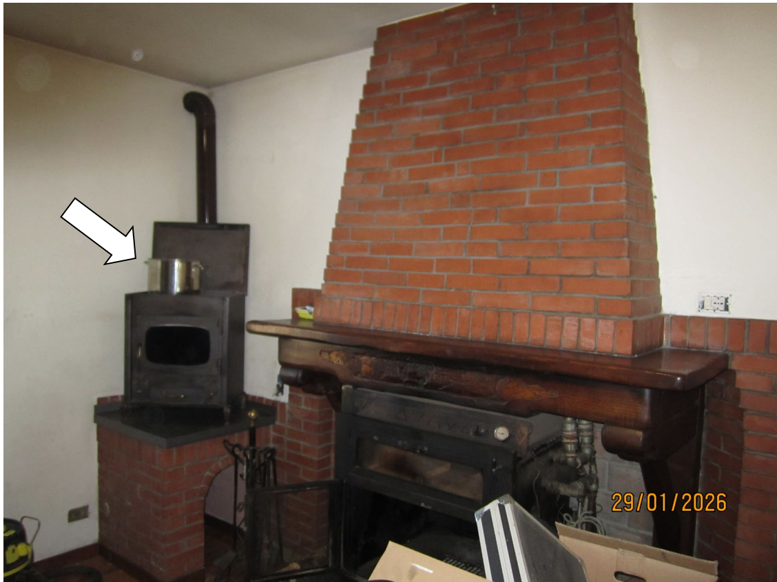
FOTO 3 – Indicata con la freccia, una stufa provvisoria a legna, appena installata, con tubazione di scarico innestata nello stesso condotto verticale raggiunto dal termocamino con tubazione metallica di tipo flessibile. Di qui la necessita' di prevedere una nuova canna fumaria esterna in acciaio rigido, coibentata, a norma, per il nuovo termocamino.
