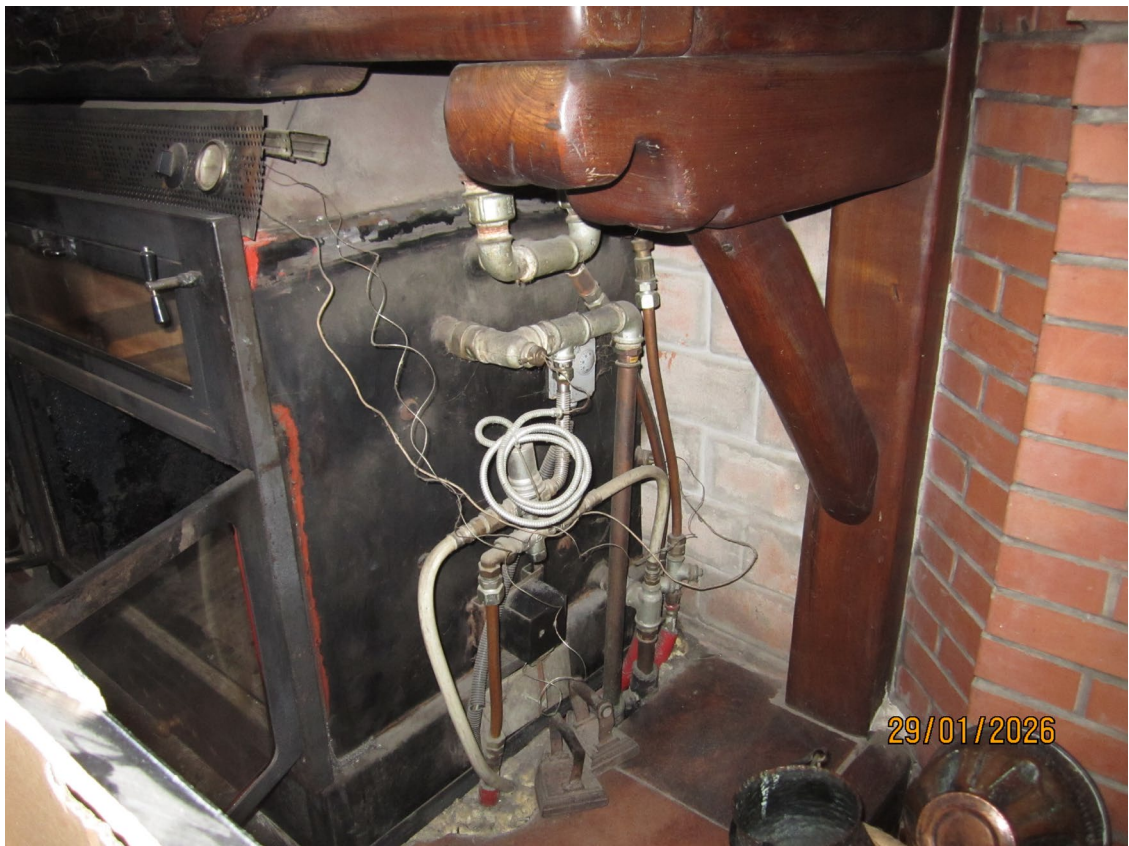
FOTO 2 – Dettaglio dei collegamenti alle tubazioni dell'impianto termico.
