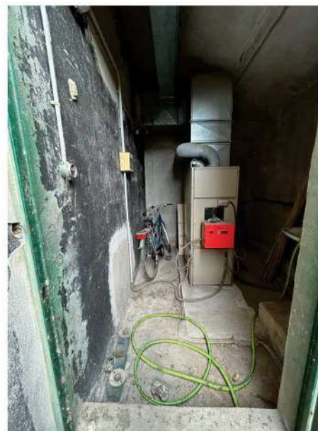
Locale caldaia nel Sub. 10 – B.C.N.C.
