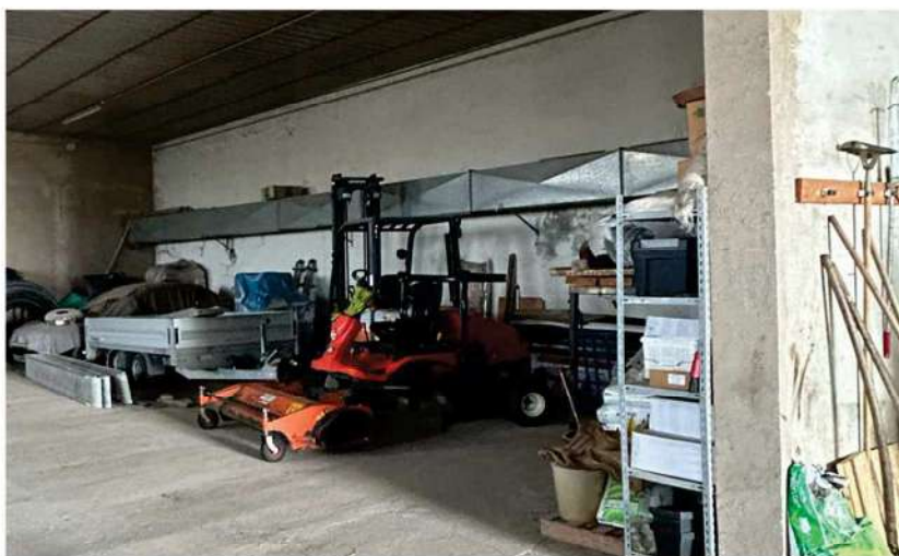
Condotta impianto riscaldamento
