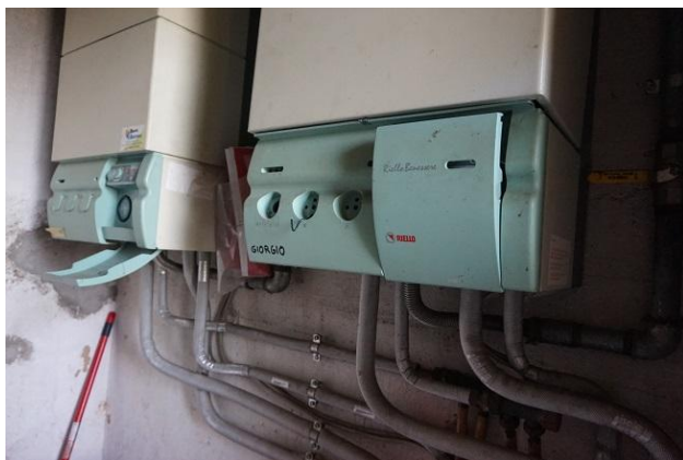
Piano terra – Caldaie
