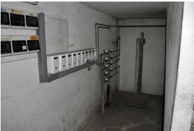
Foto 33 – vano tecnico contatori – P.ST
