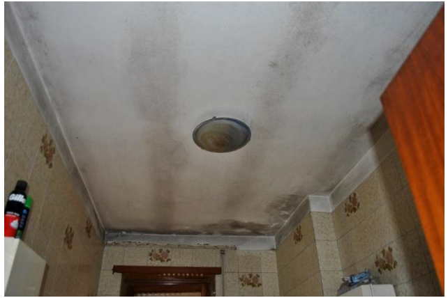
Foto 26 – bagno P.3 - soffitto
