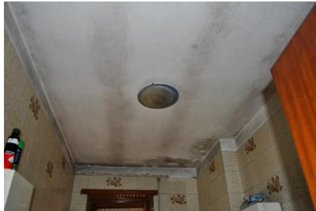
Foto 26 – bagno P.3 - soffitto
