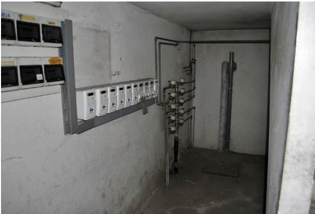
Foto 33 – vano tecnico contatori – P.ST
