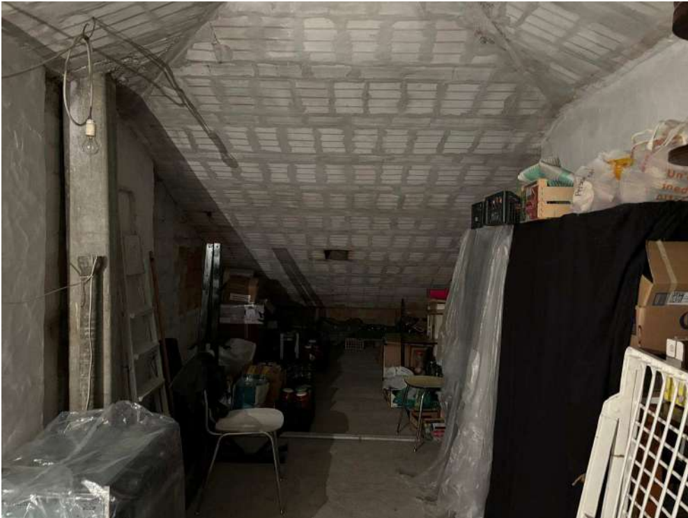
FOTO 20 – SOFFITTA APPARTAMENTO SUB.3
