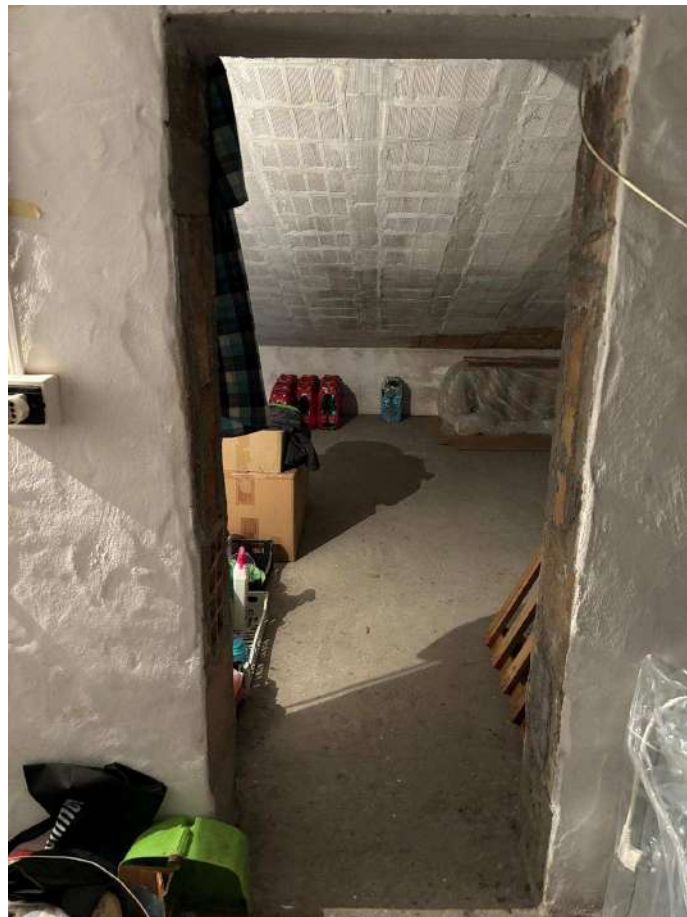
FOTO 21 – SOFFITTA APPARTAMENTO SUB.3
