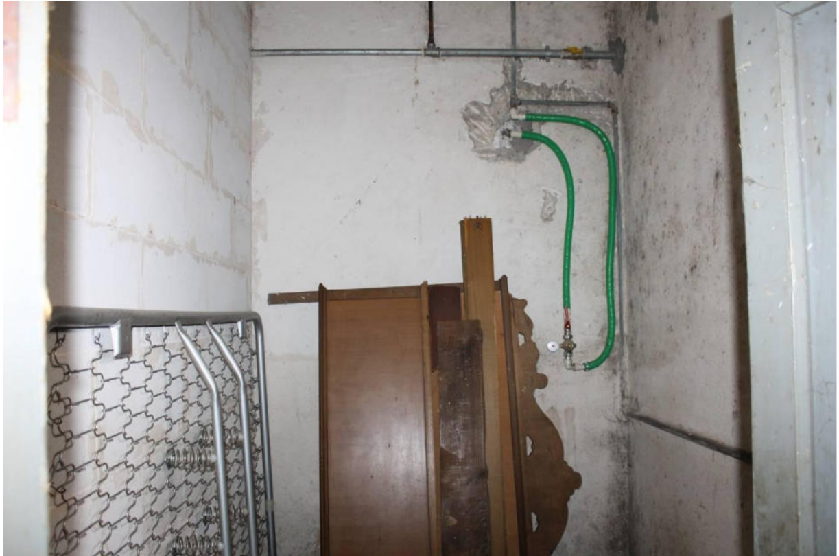
FOTO N. 9 - Vista interna della civile abitazione (sub 2 - piano seminterrato): vano tecnico
