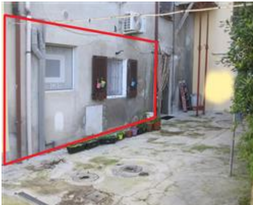
Retro del fabbricato con localizzazione dell'unità immobiliare oggetto di perizia e dello scoperto comune
