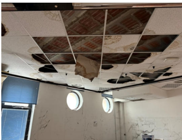
16 – infiltrazioni su copertura negozio principale
