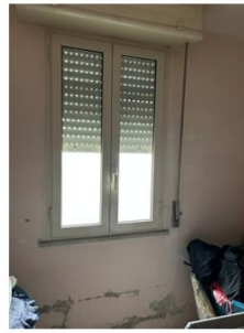
Foto n. 39 - Camera n.1 - particolare delle macchie da infiltrazione
