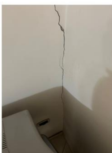
Foto n. 56 - Camera n.2 - particolare delle lesioni
