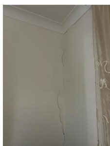
Foto n. 54 - Camera n.2 - particolare delle lesioni
