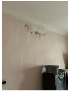
Foto n. 38 - Camera n.1 - particolare delle macchie da infiltrazione
