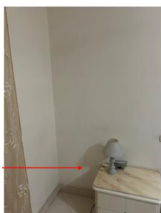
Foto n. 52 - Camera n.2 - particolare delle lesioni
