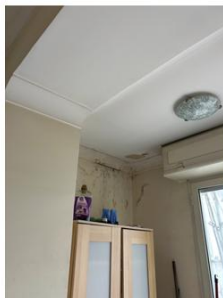
Foto n. 22 - Disimpegno - particolare delle macchie di infiltrazione e delle lesioni
