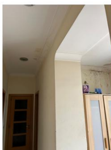
Foto n. 21 - Corridoio verso il disimpegno - particolare delle macchie di infiltrazione e delle lesioni
