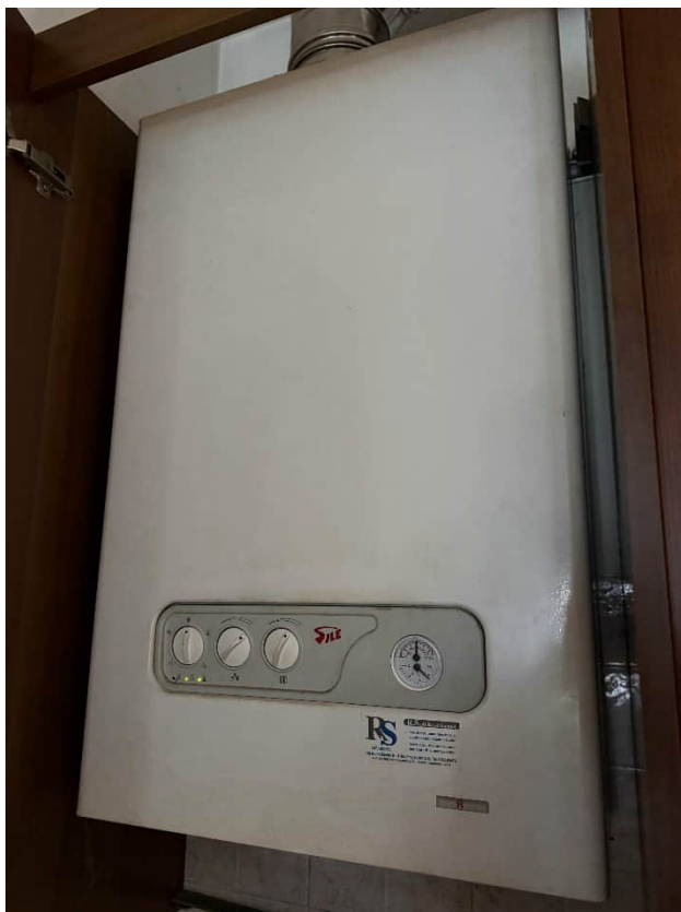
Foto n°14: caldaia nel mobile cucina.
