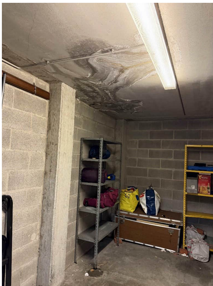
Foto n°24: avvenute infiltrazioni a soffitto (solaio piano interrato/terra).
