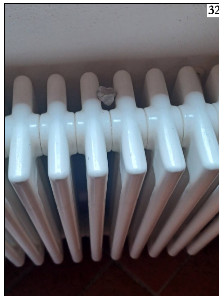
DETTAGLIO RADIATORE IRSAP
