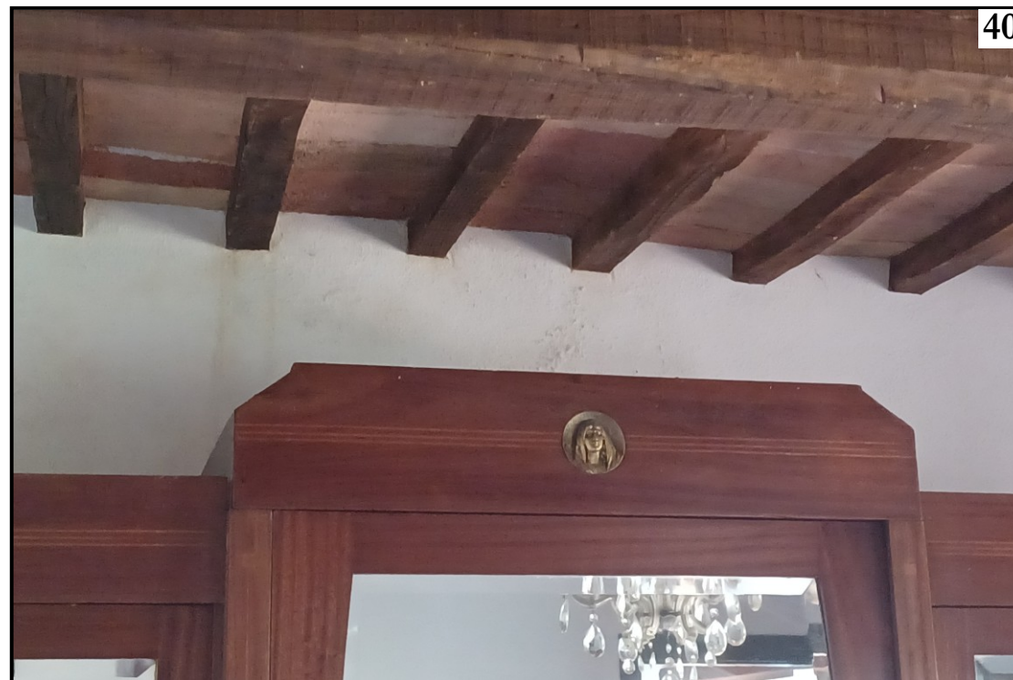
INFILTRAZIONE PROVENIENTE DA TERRAZZA
