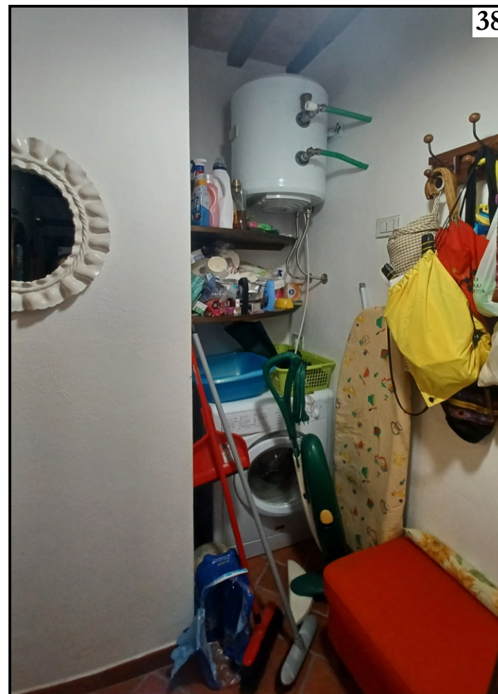
BOILER NEL RIPOSTIGLIO AL P1
