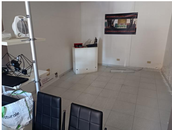
Foto 5: vano di fondo del locale ed effetti di umidità di risalita, maggiori nella parete a destra
