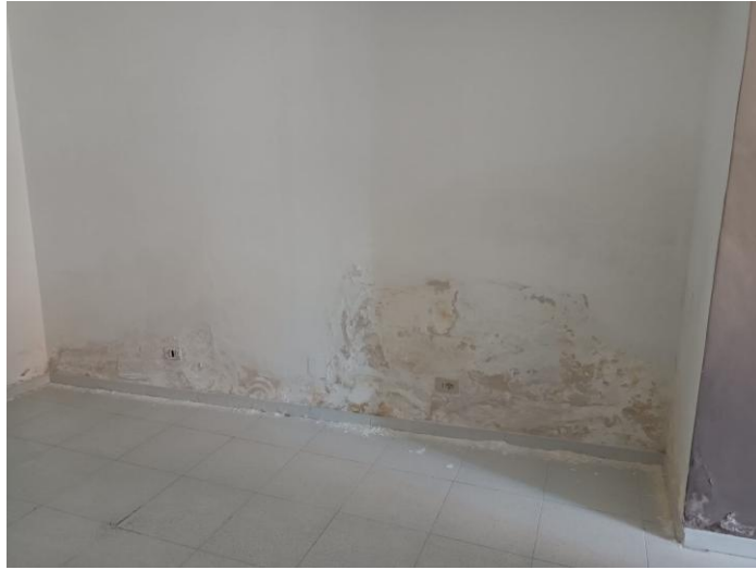
Foto 10: effetto di umidità di risalita nella parete in fondo a destra
