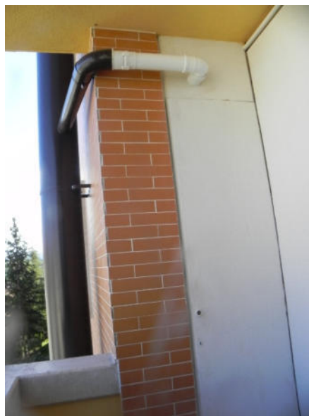
balcone con caldaia
