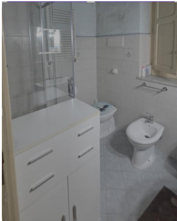
Foto 6: wcd con finestra sulla corte. Visibili effetti di condensa sulle pareti (ed anche sul soffitto)
