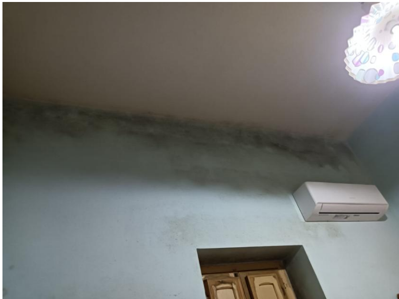
Foto 8: effetti di condensa più accentuati nella stanza dalla cucina in fondo a destra (oltre che nel wcd)
