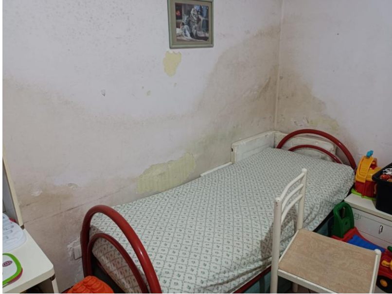
Foto 7: umidità di risalita presente in modo generalizzato, qui con effetto molto vistoso (prima stanza dalla cucina in fondo a sinistra)
