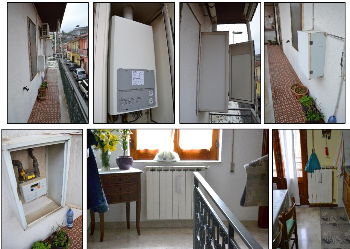
Figura 19 – Contatore gas metano e caldaia
