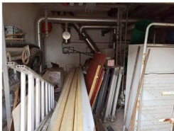
FOTO 32 - LOCALE TECNICO, VISTA INTERNA
