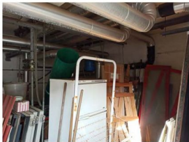
FOTO 33 - LOCALE TECNICO, VISTA INTERNA
