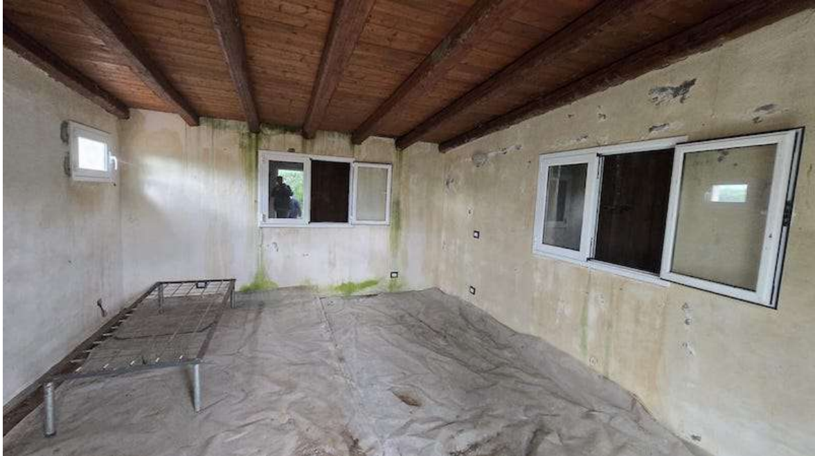
Foto 63 – Lotto unico – Fabbricato in abuso piano primo particella 184
