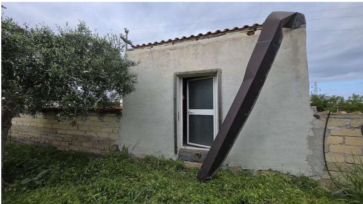
Foto 62 – Lotto unico – Fabbricato in abuso piano primo particella 184
