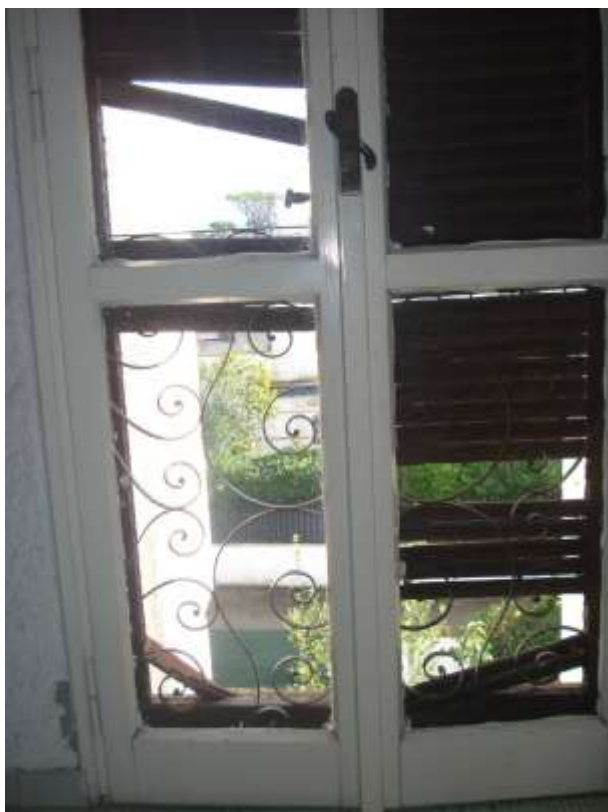
FOTO n° 30 : Ecco le condizioni dell'infisso esterno in legno, (persiana) dell'affaccio sul pianerottolo.
