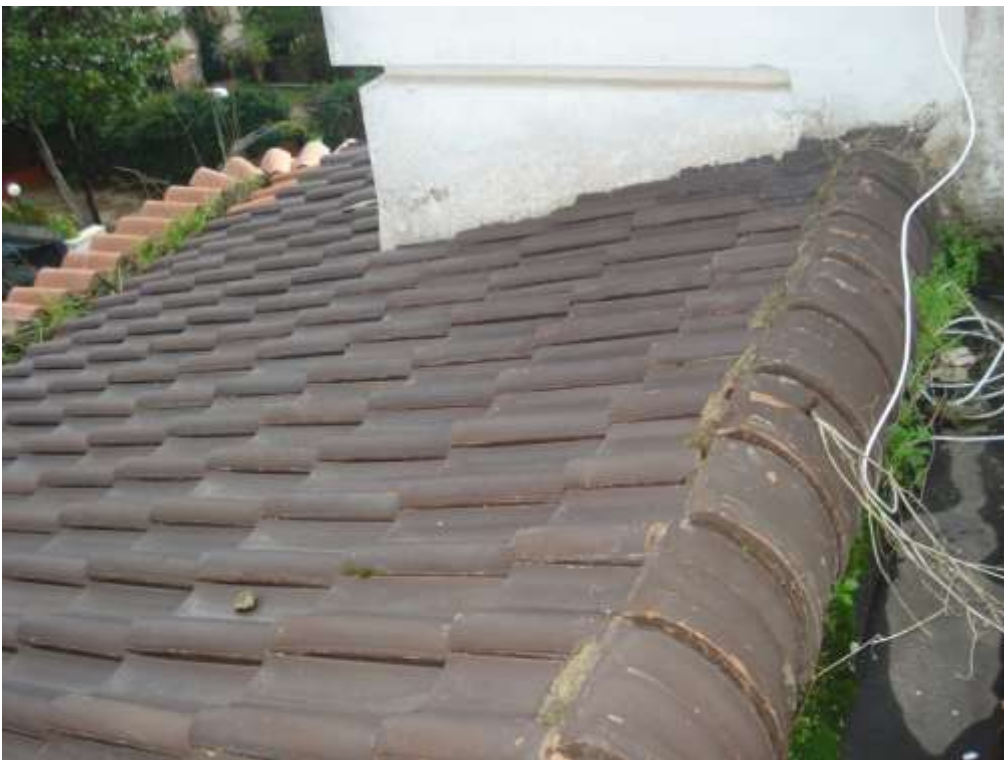
FOTO n° 50 : Vista dell'a parte più bassa della falda del tetto ripresa dal colmo basso Anche qui si evidenziano le sconnessioni presenti sul colmo e addirittura la presenza di erbacce sulla parte di guaina che procurano infiltrazioni verso il basso, (3ª camera ).
