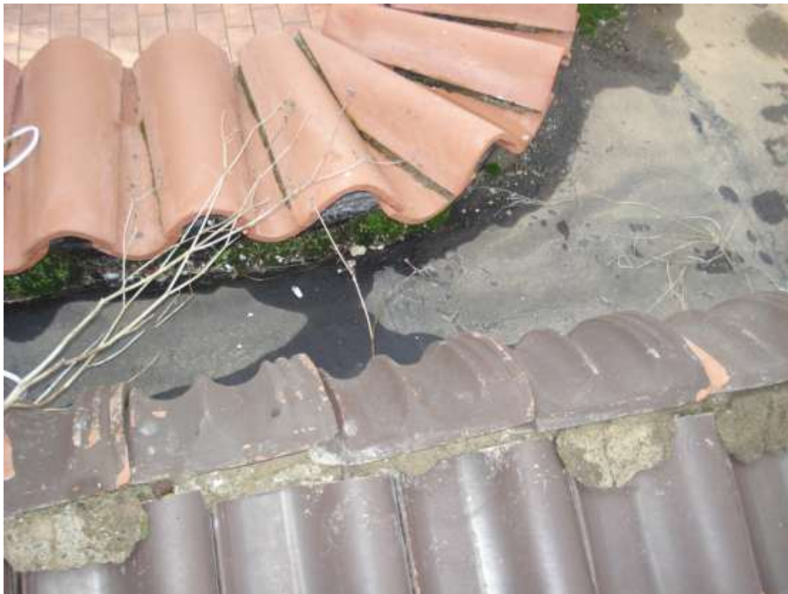
FOTO n° 56 : Particolare della presenza di erbacce e radici sulla guaina e la sconessione dei coppi di colmo e delle tegole.
