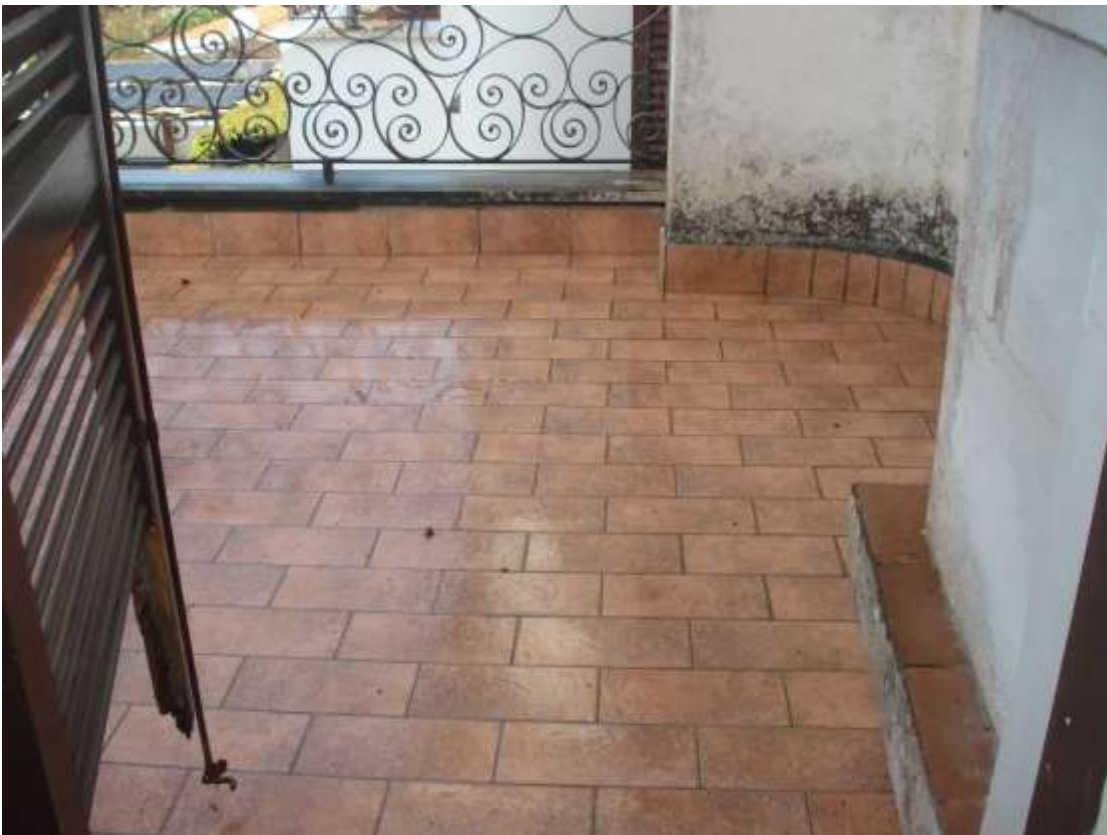
FOTO n° 44 : Altro particolare del terrazzo Si notano le pessime condizioni dell'infisso e il degrado degli intonaci.
