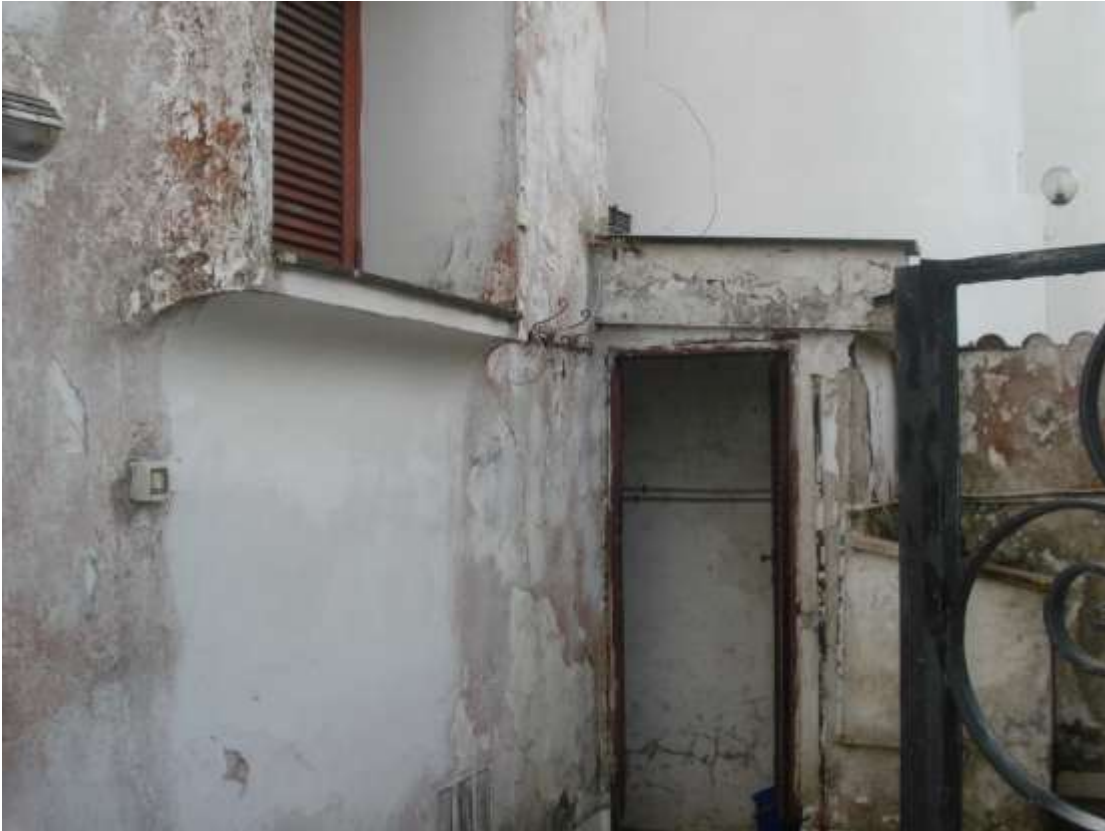
FOTO n° 5: Il lato Ovest, con l'entrata del vano cantina al Piano Seminterrato. Si nota già lo stato di degrado dei materiali, intonaci e infissi.
