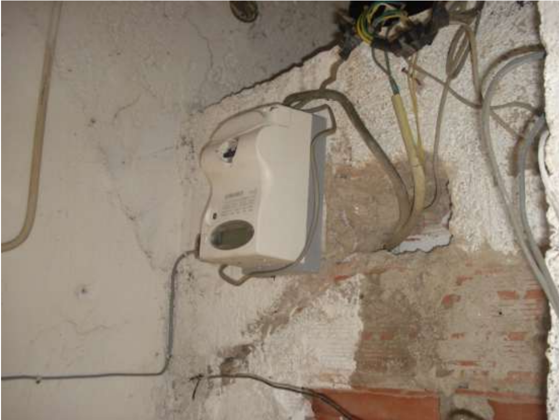
FOTO n° 11: Scendendo i primi gradini della scala, sulla parete di sinistra, è presente il Misuratore Elettrico.
