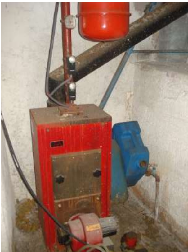
FOTO n° 14: Particolare della Caldaia alimentata a Gasolio e/o cherosene per l'impianto termico.
