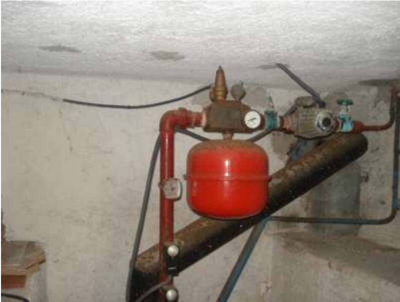
FOTO n° 15: Particolare della Caldaia.
