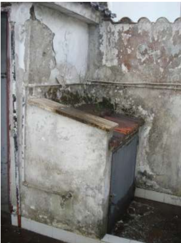
FOTO n°6: Particolare del piccolo manufatto dove è ubicato il pozzo artesiano dell'acqua e l'autoclave, inoltre si nota la presenza della doccia all'aperto per il periodo estivo e la presenza di umidità.
