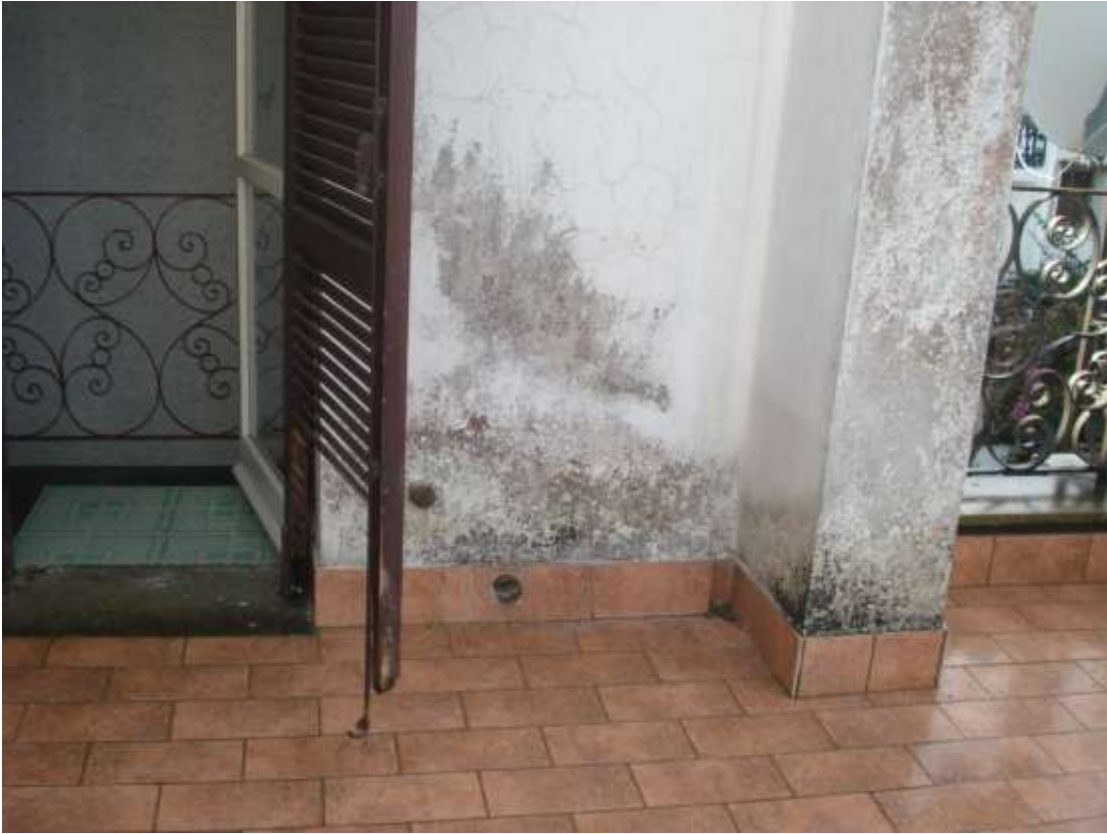
FOTO n° 43 : L'uscita sul terrazzo Si notano le pessime condizioni dell'infisso e il degrado degli intonaci.
