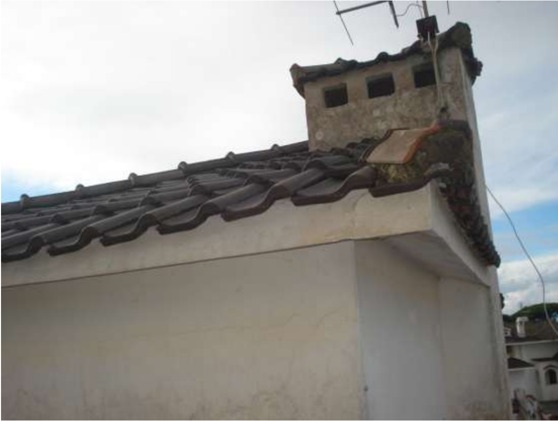
FOTO n° 55 : Particolare vista del tetto, lato Est si notano le sconessioni delle tegole.
