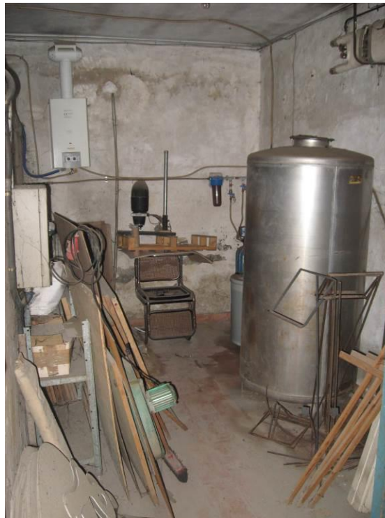
Figura 23 locale tecnico al piano interrato comune a tutti i beni pignorati
