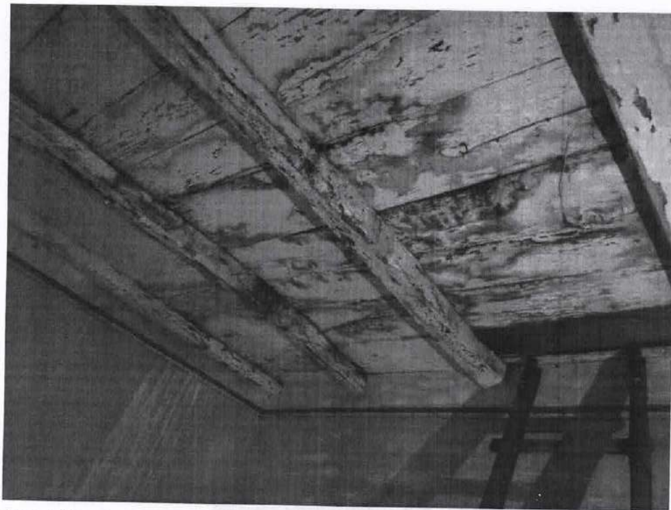
Foto n°25: marcescenza solaio di copertura del piano primo
