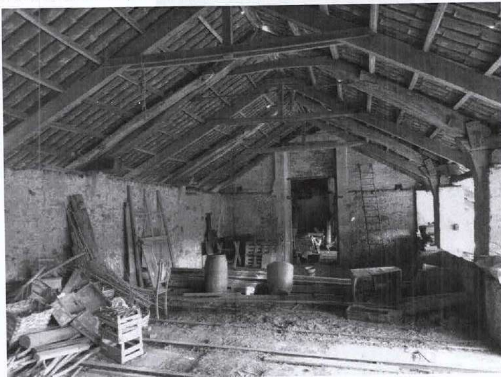
Foto n°30: volume soprastante il solaio della foto n°23, copertura con diffusi fori (dai quali filtra la luce solare)
