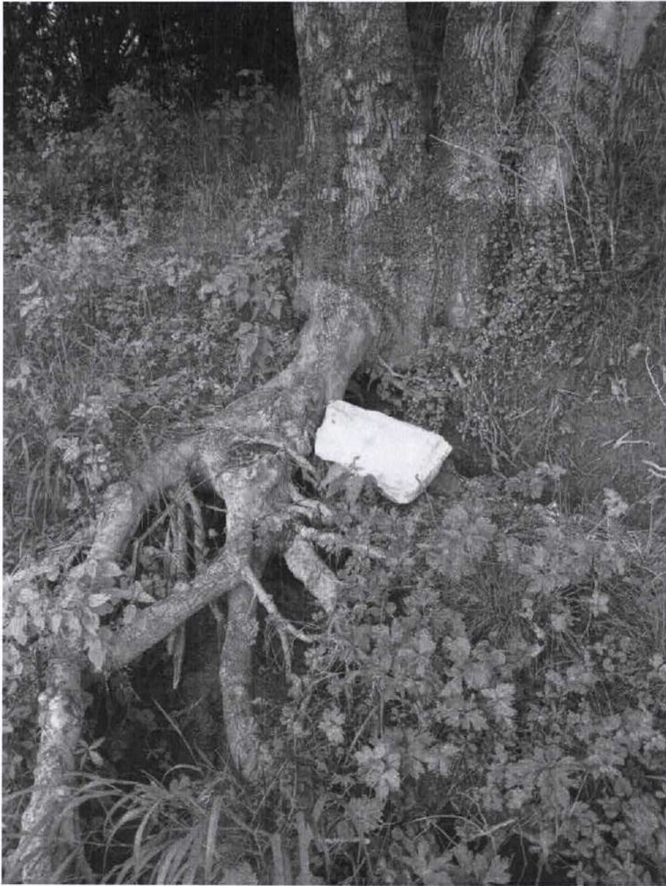
Foto n°19: erosioni localizzate a valle del punto di sbocco della tubazione fognaria
