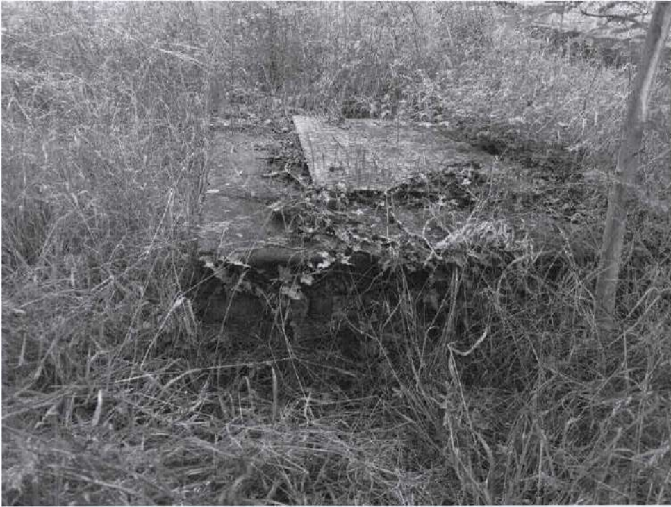
Foto n°13: erosione del terreno intorno al pozzetto Ovest
