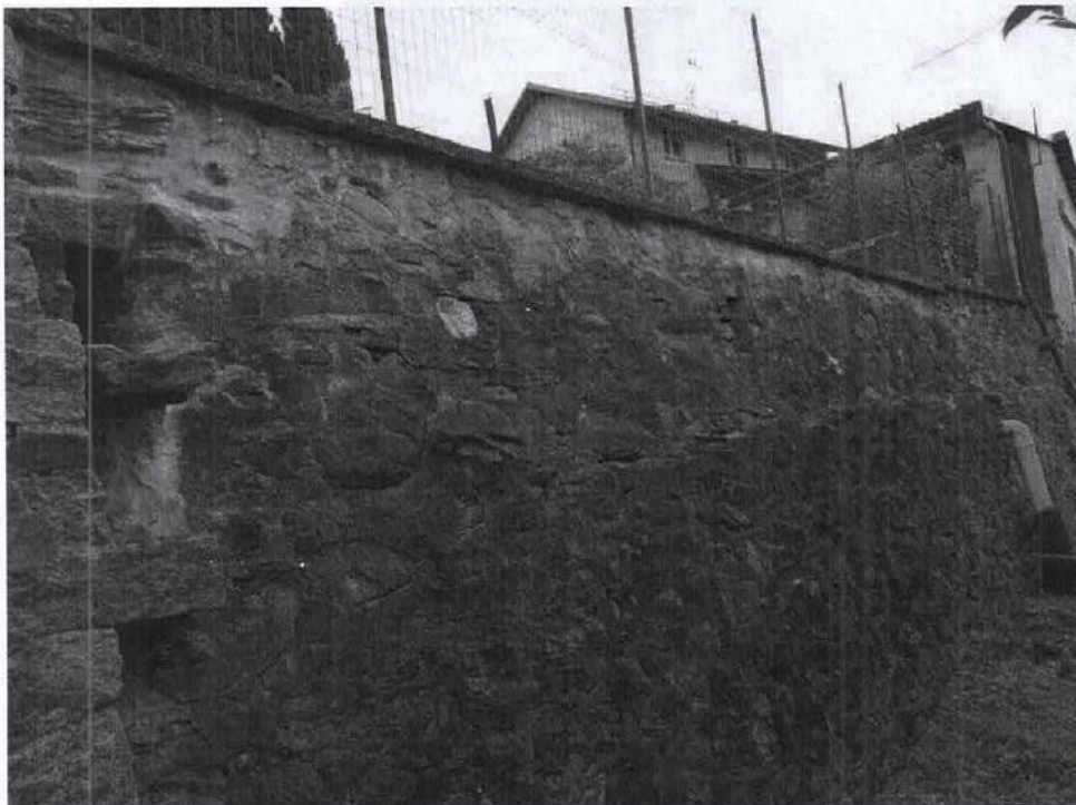
Foto n°8: doccioni e finestrature nel muro che scaricano sul sedime del vicolo
