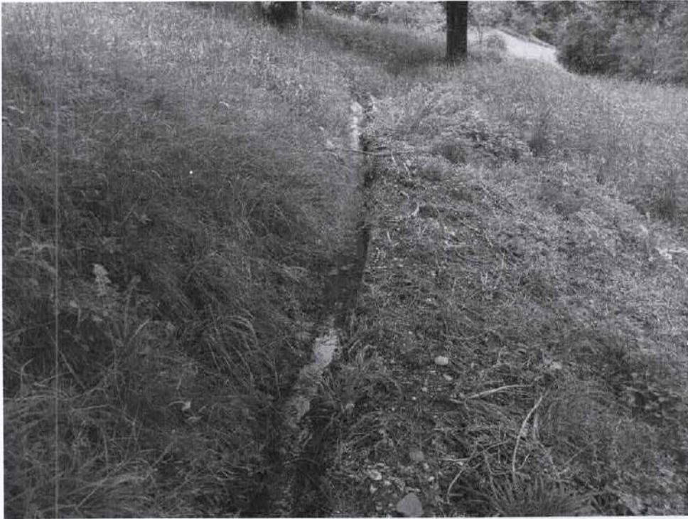
Foto n°17: cunetta in terra percorsa dai reflui fognari
