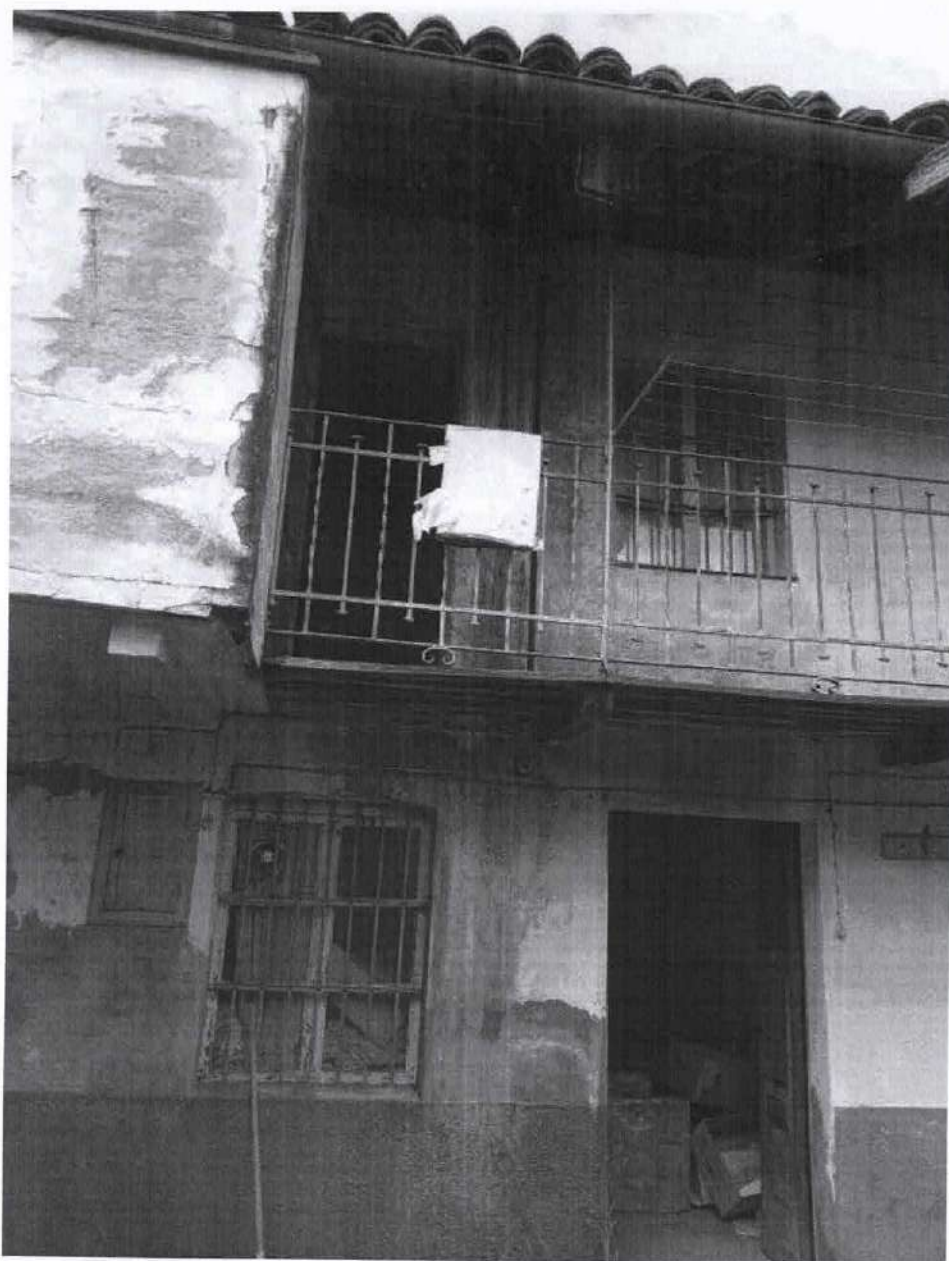
Foto n°22: edificio civico n°126, colature d'acqua proveniente dal tetto e muffe sulla facciata
