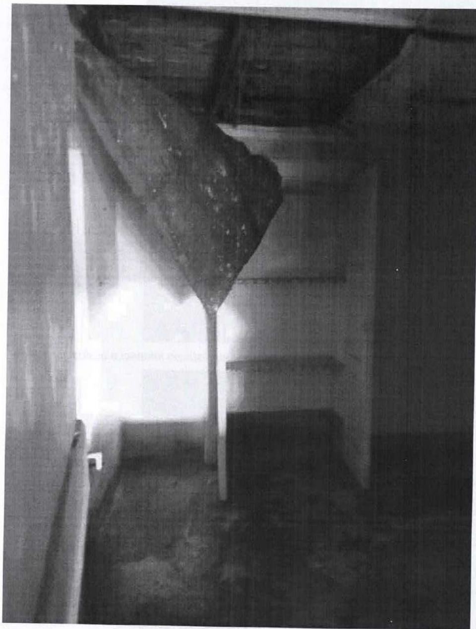
Foto n°28: marcescenza e crollo controsoffitto solaio di copertura del piano primo, acqua sul pavimento
