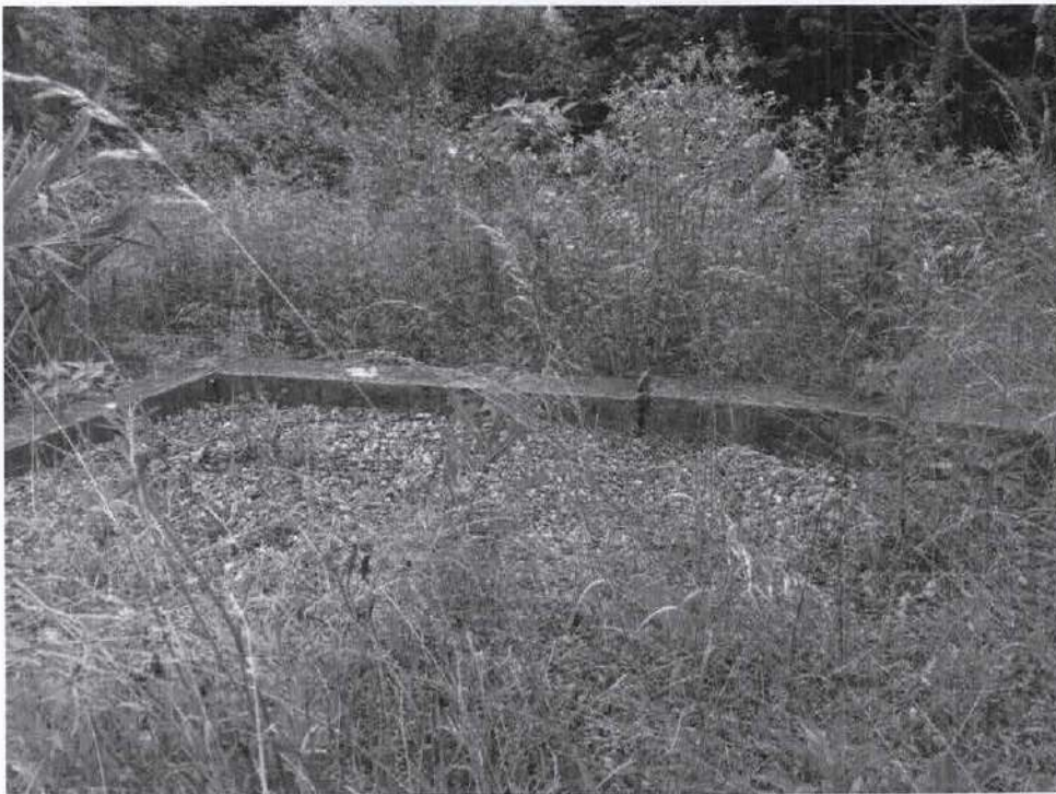
Foto n°14: cordolatura del cortile Sud fratturata e disarticolata
