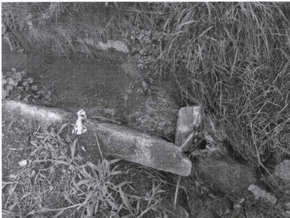
Foto n°20: materiale depositato dai reflui fognari
