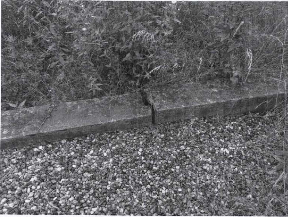
Foto n°15: dettaglio frattura cordolatura della foto precedente
