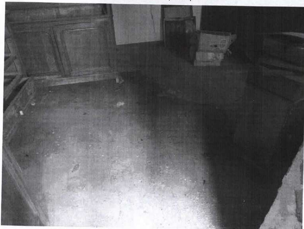
Foto n°26: pozze d'acqua sul pavimento del piano primo
