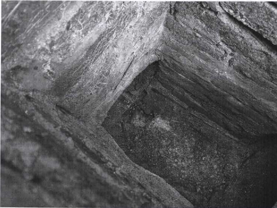
Foto n°6: pozzetto fognario, fondo scorrevole eroso
