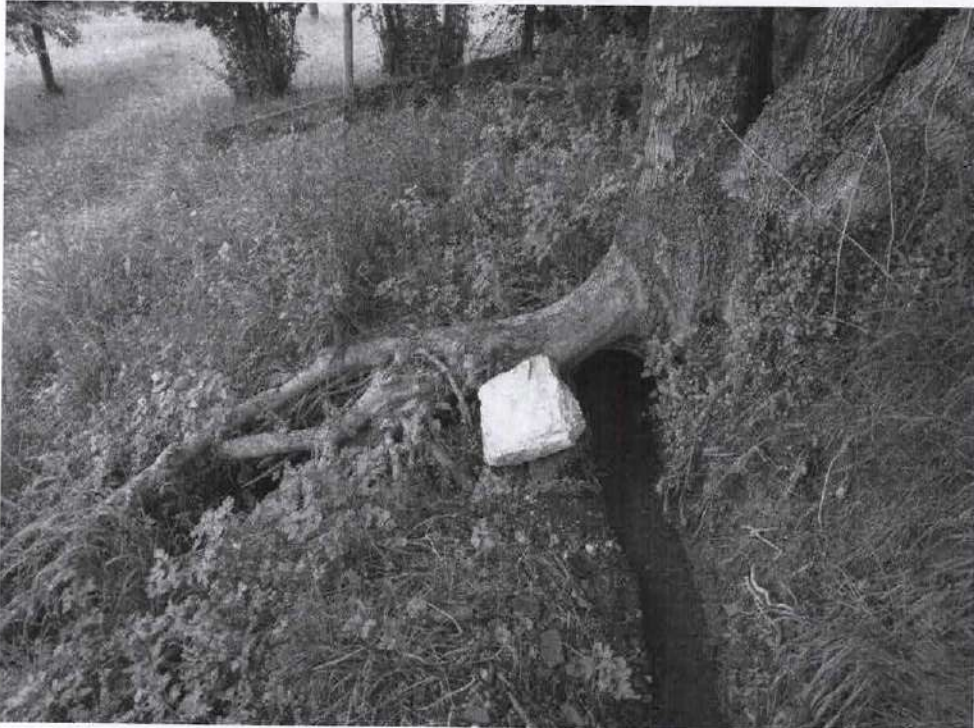
Foto n°16: punto di venuta a giorno della condotta fognaria, presso il vertice SO dell'area pertinenziale
