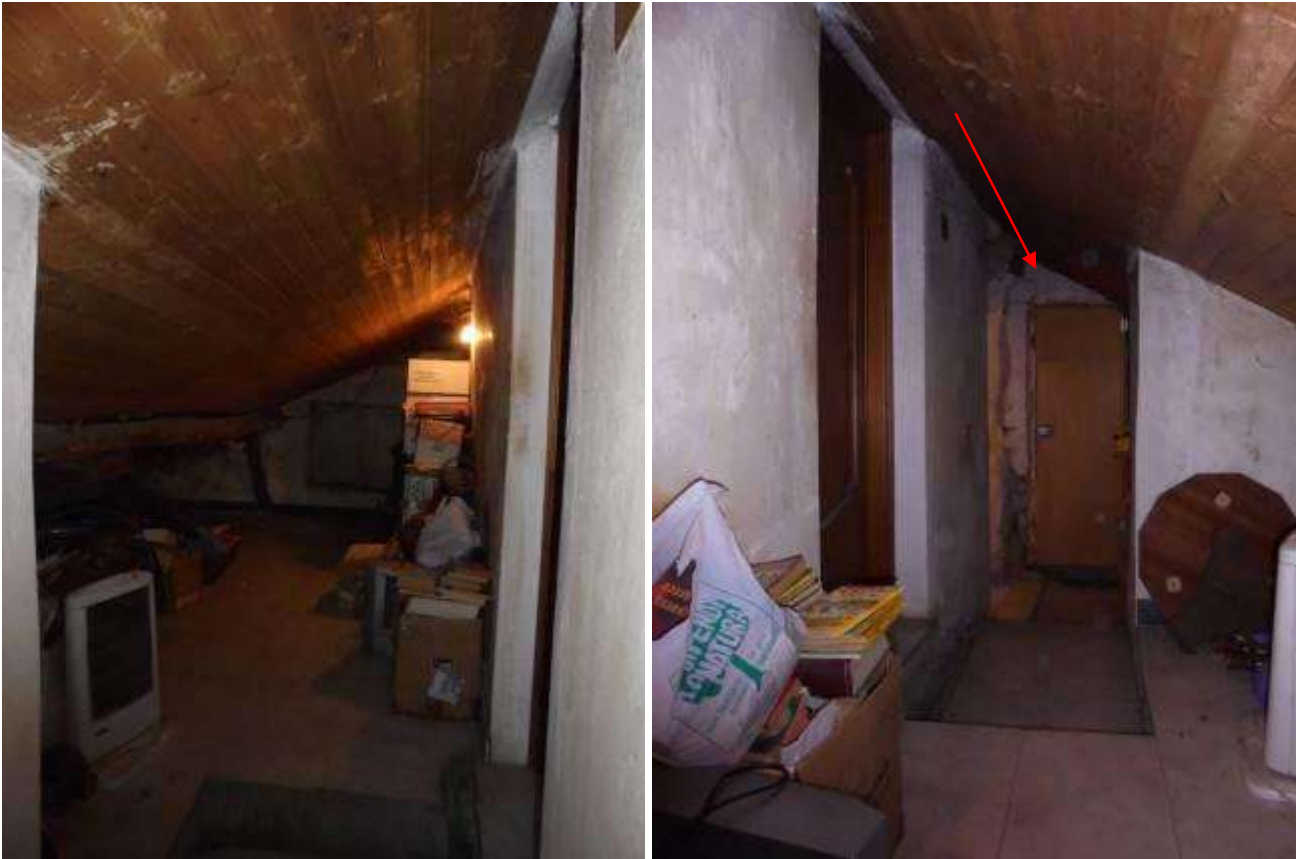
Foto 42 e 43 – Vista del locale tecnico al piano primo sottotetto In evidenza la porta che da accesso al ripostiglio oltreché anche all'appartamento al civico 26 che non è stato ispezionato perché inagibile e pericolante
