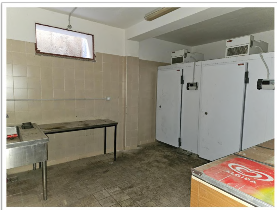
Foto 24 – Locale celle frigorifere – piano seminterrato
