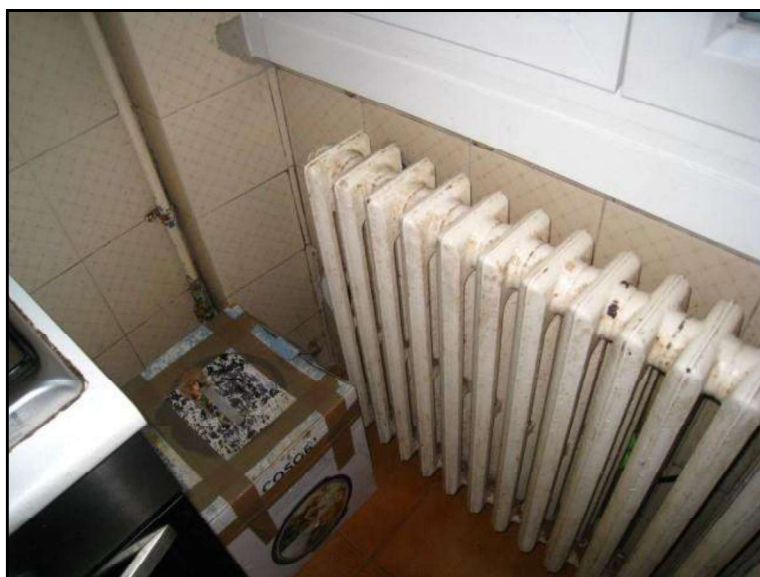
FOTO 12 U.I. MAPPALE 816 SUB. 17 – PIANO SECONDO VISTA PARTICOLARE SOTTOFINESTRA DELLA CUCINA.
