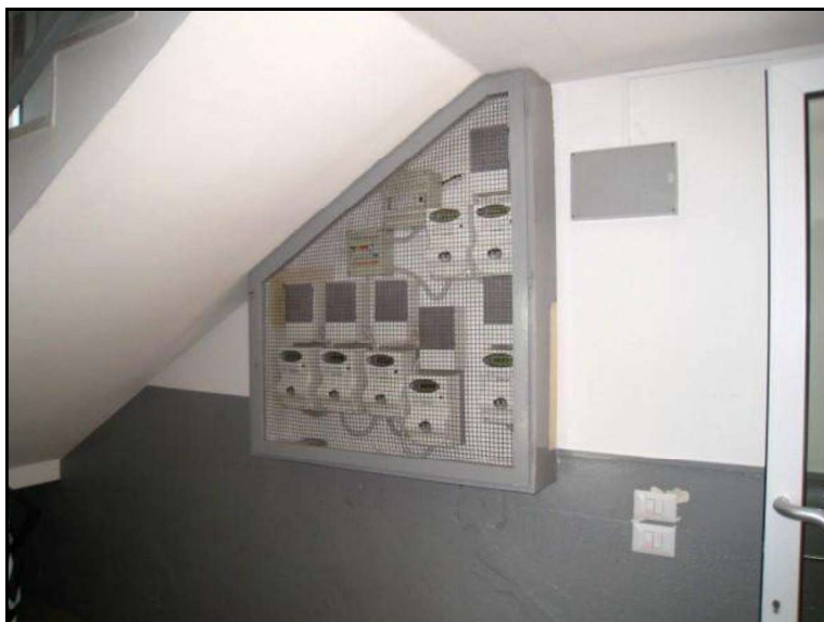
FOTO 38 PIANO TERRA VISTA NICCHIA CONTATORI ENERGIA ELETTRICA POSTI NELL'ANDRONE SOTTOSCALA.
