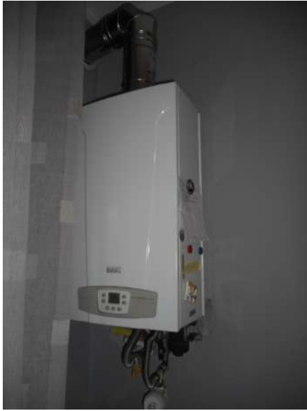
Foto 19- caldaia a gas
