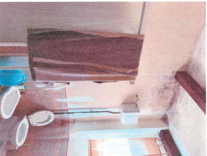
Foto 11 Ripresa delle infiltrazioni di acqua piovana dal solaio di copertura nel bagno
