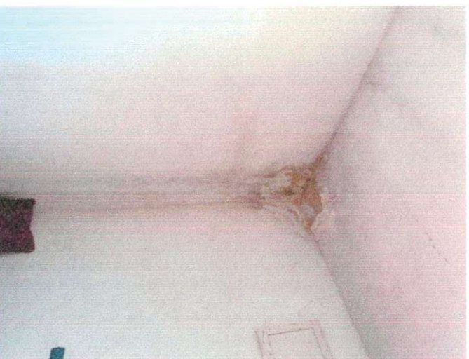
Foto 9 Ripresa delle infiltrazioni di acqua piovana e crepe sul solaio
